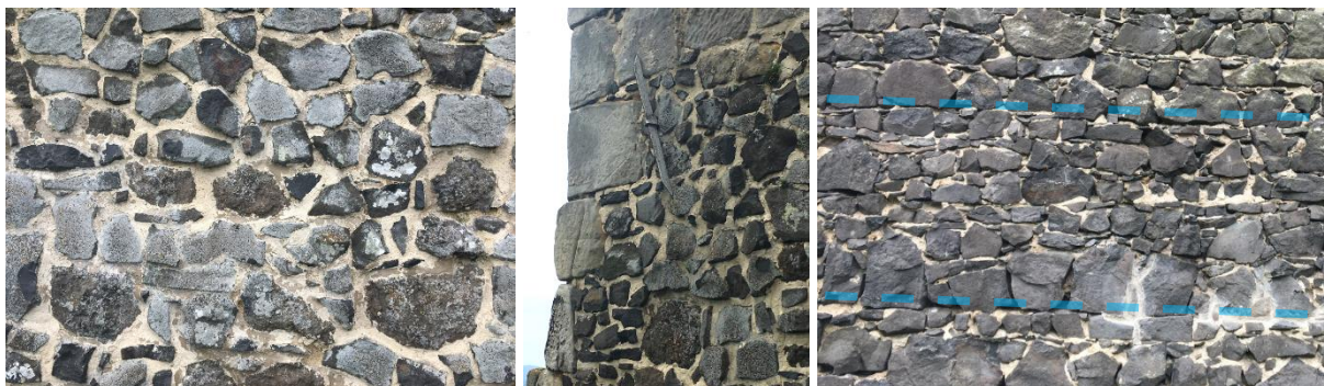
Obrázek 3: Zřícenina hradu Trosky, Český Ráj: a) lomové zdivo z čedičových zdicích prvků, b) osazení velkých ztužujících nárožních kvádrů, c) vrstvy lomového zdiva mohou někdy začínat většími bloky a do další průběžné ložné spáry jsou doplněny menšími úlomky kamene
