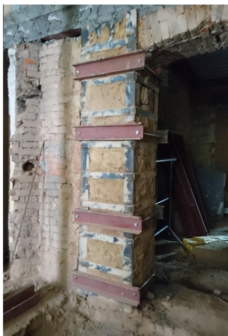
Obrázek 15: Sevření zdiva pilíře páskovou ocelí. Měšťanský dům Plzeň, Tylova ulice.
