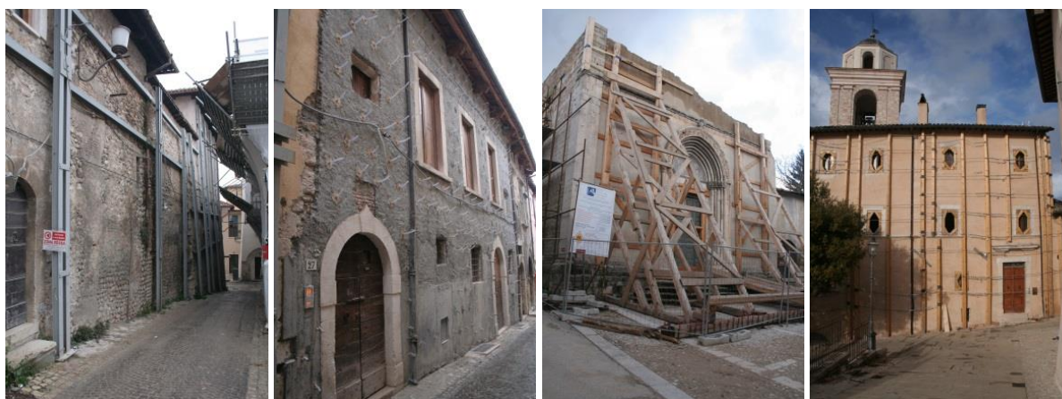
Obrázek 22: Historické jádro města Norcia: standardní metody provizorní stabilizace zděných konstrukcí poničených zemětřesením jsou založeny na dřevěném / ocelovém pažení.
