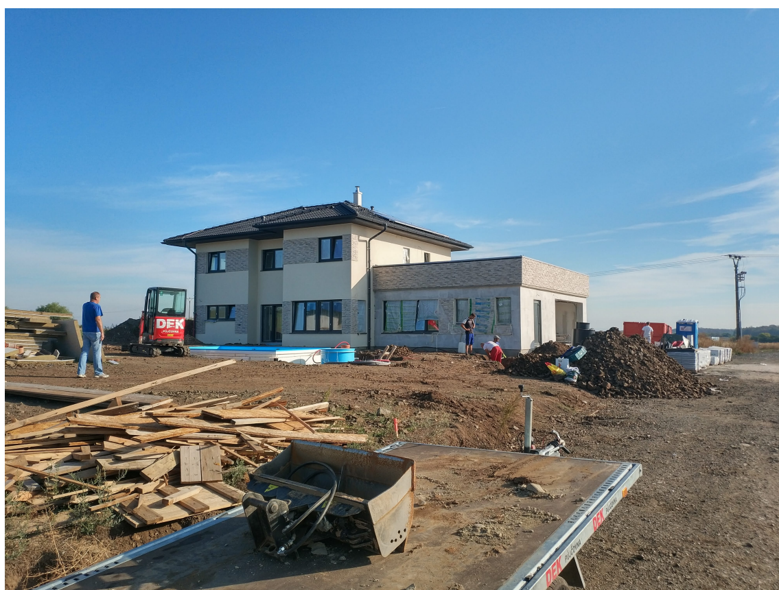
Obrázek 7.1: Rodinný dům s instalovaným FV zdrojem
