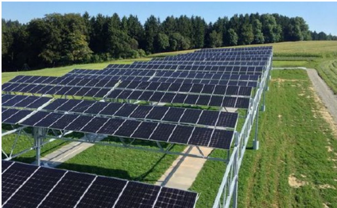
Obr. 32 - FVE na konstrukci cca 5 metrů na zemi [8]
