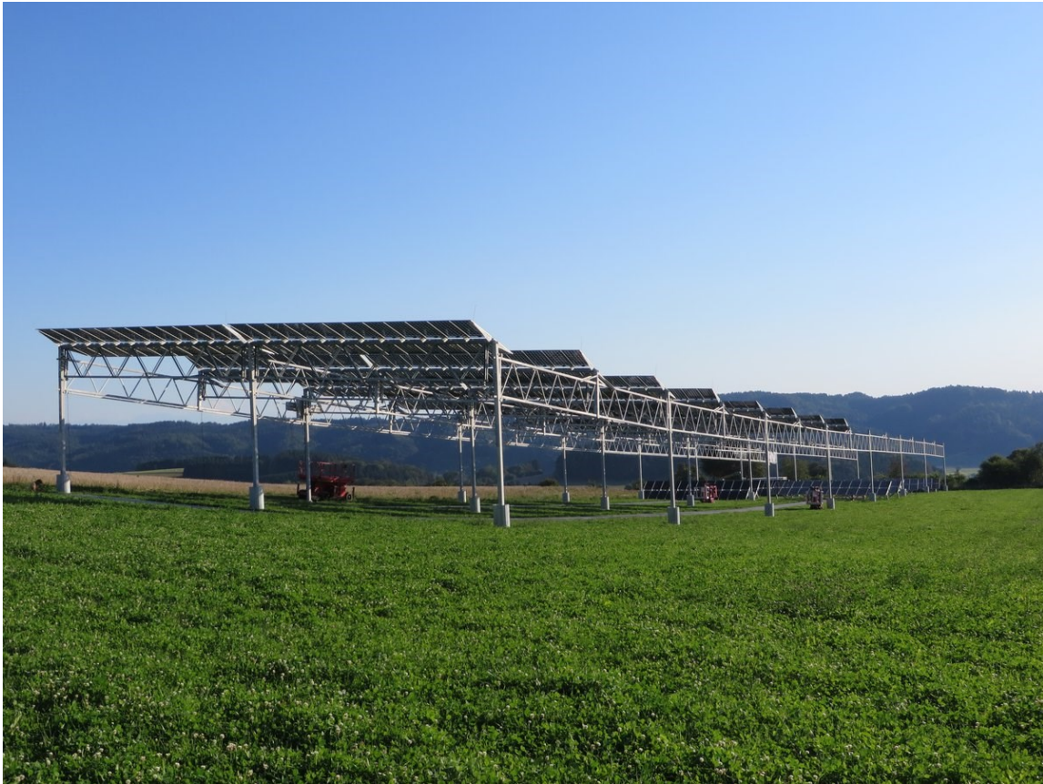
Obr. 31 - FVE na konstrukci cca 5 metrů nad zemí [8]
