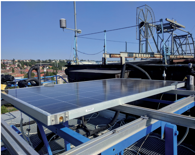
Obr. 3 Nezasklený FVT kolektor VAR1(vlevo) a IVAR (vpravo)
