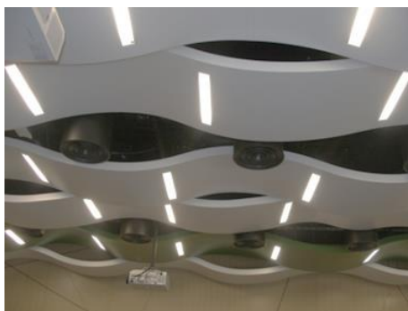
6.7 Obr. Přívod vzduchu anemostaty v posluchárně C215 (autor)
