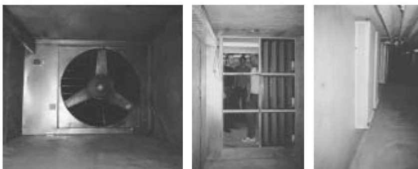
2.19 Obr. Panel filtrů (celkem šest, tři kazety vlevo jsou na tomto obrázku odstraněny) na konci zabudovaného přívodního kanálu (vpravo), tlumiče hluku v distribuční komoře (uprostřed) a odsávací ventilátor v odváděcí věži (vlevo) - (Kleiven, 2003)
