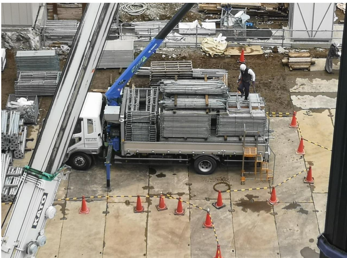
Obrázek 20: Zajištění bezpečnosti při vykládce materiálu z korby nákladního auta, vymezení ohroženého prostoru a komunikačních koridorů [archiv autora]
