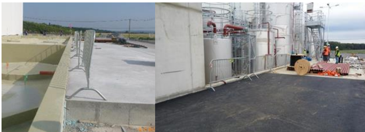
Obrázek 5 (vlevo): Nedostatečně zabezpečená pádová hrana [archiv autora]
