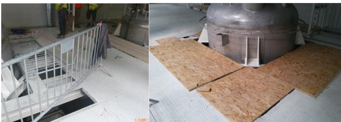
Obrázek 7 (vlevo): Nezabezpečený otvor v podlaze ve výšce 12m [archiv autora]
