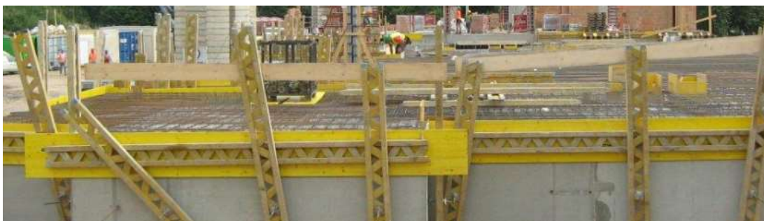
Obrázek 26 - Dočasné zábradlí na střešní konstrukci [23]
