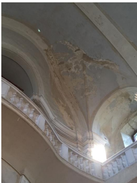
obr. 2.31 Poruchy zatékáním srážkové vody
