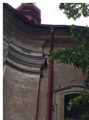
obr. 2.39 Trhlina v okapní římse
