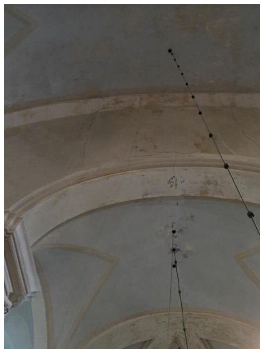
obr. 2.32 Vlhkostní mapy na stropní konstrukci
