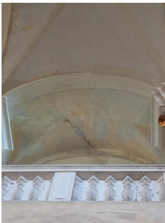
obr. 2.36 Trhlina vnitřní klenby na hlavní lodi
