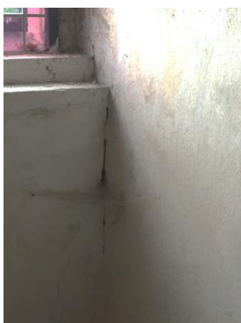
obr. 2.38 Trhlina v místě parapetu
