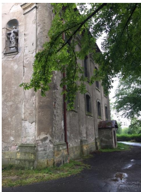
obr. 2.35 Projevy vlhkosti na fasádě
