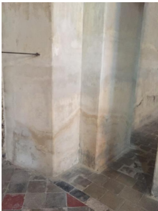
obr. 2.33 Projevy vztlínající vody v hlavní lodi
