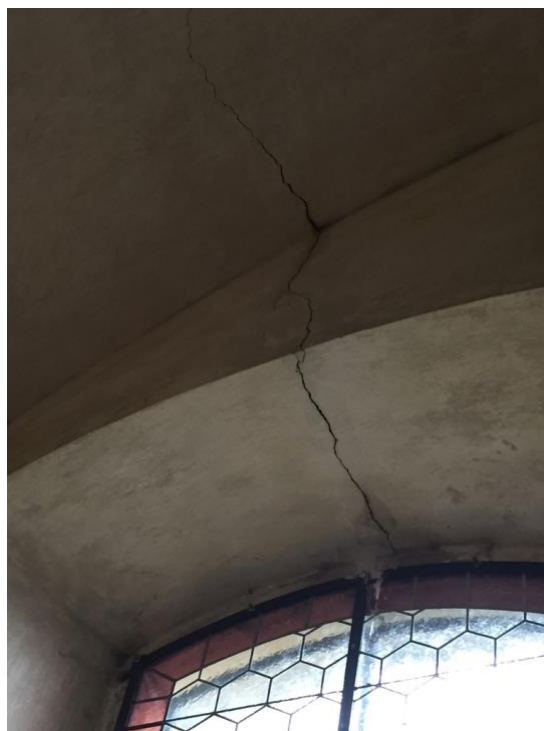
obr. 2.37 Trhlina v klenbě okenního otvoru
