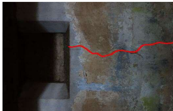
Obrázek 62 - trhlina T3 [autor]
