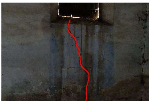
Obrázek 63 - trhlina T5 [autor]
