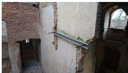
Obrázek 21 - provizorní ocelové táhlo v kapli [autor]
