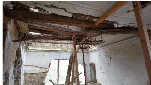
Obrázek 23 - propadlý strop se štukovým zrcadlem [autor]
