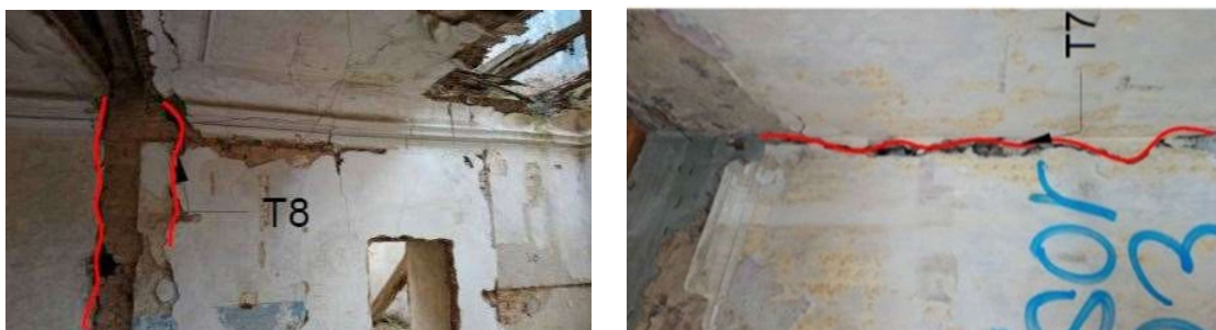
Obrázek 36 - fotodokumentace svislých trhlín [autor]
