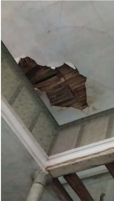
Obrázek 55 - lokálně porušená nepravá klenba [autor]
