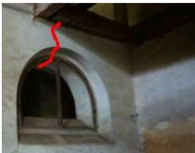
Obrázek 64 - trhlina T2 [autor]
