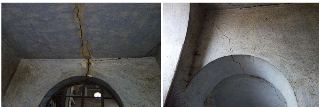
Obrázek 60 - fotodokumentace stropní trhliny T1 [autor]
