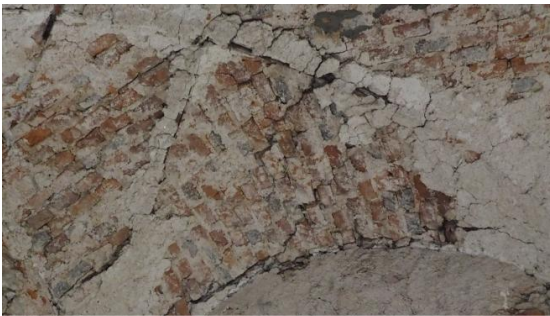
Obr.34: Porušení trhlinami klenební výseče
