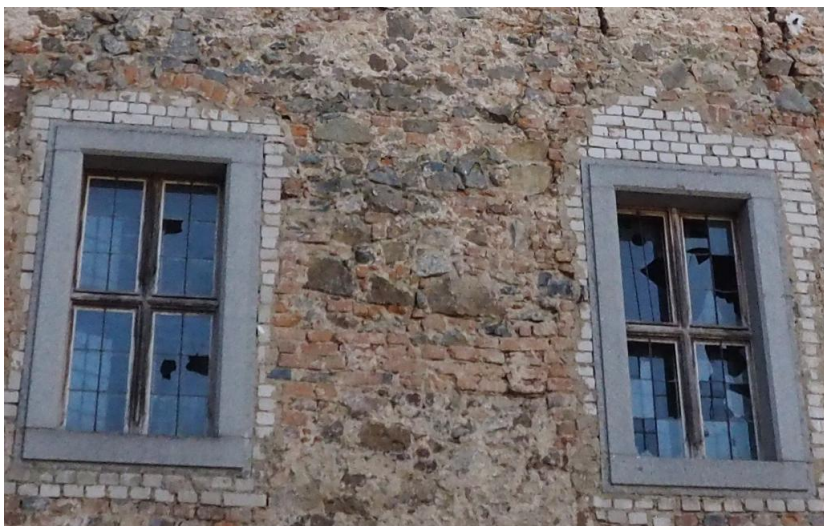
Obr.30: Dozdění původní špalety a porušení cihelného vylehčovacího pásu
