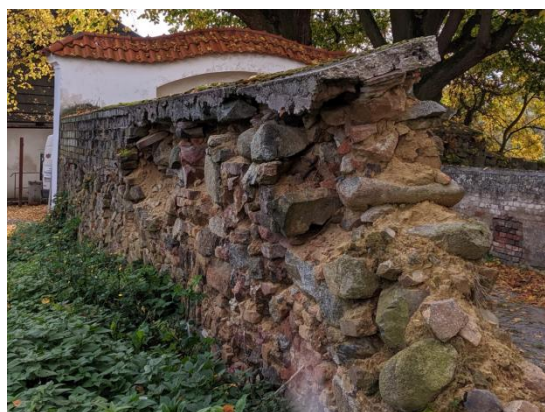
Obr.55: Naklonění a degradace mostní zidky
