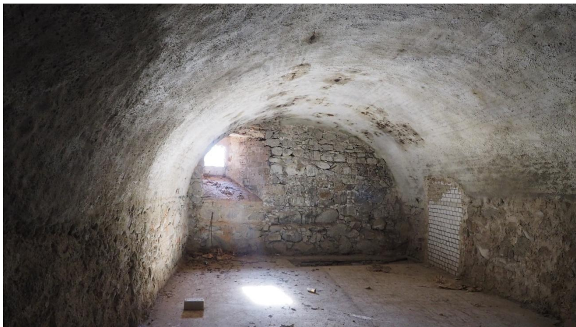
Obr. 15: Suterénní valená klenba zajištěná tokretováním
