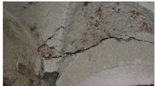
Obr.35: Cementová vyspráva a porušení v uložení klenby
