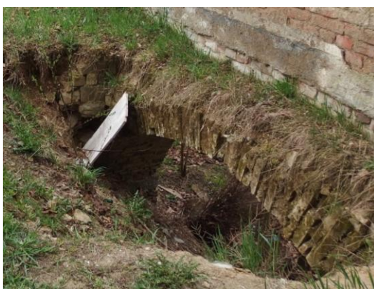
Obr:54: Stav prvního mostního pole
