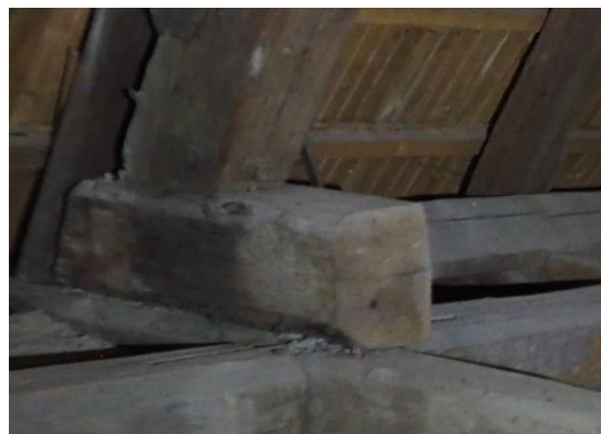
Obr.49: Nevhodné napojení vzpěradla
