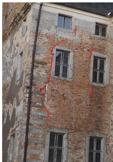
Obr.38: Trhliny propasané ve fasádě
