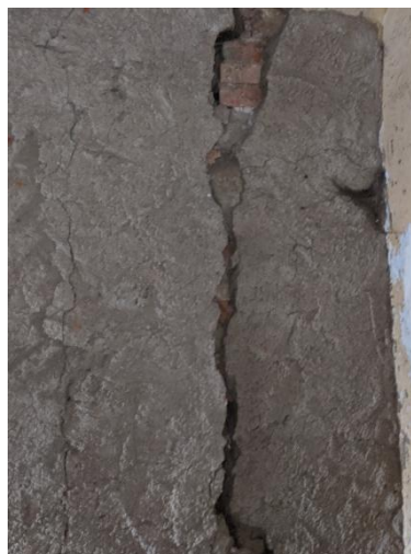
Obr.53: Trhlina v příčné stěně
