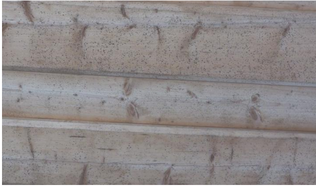
Obr:46: Napadení trámového záklopu červotočem
