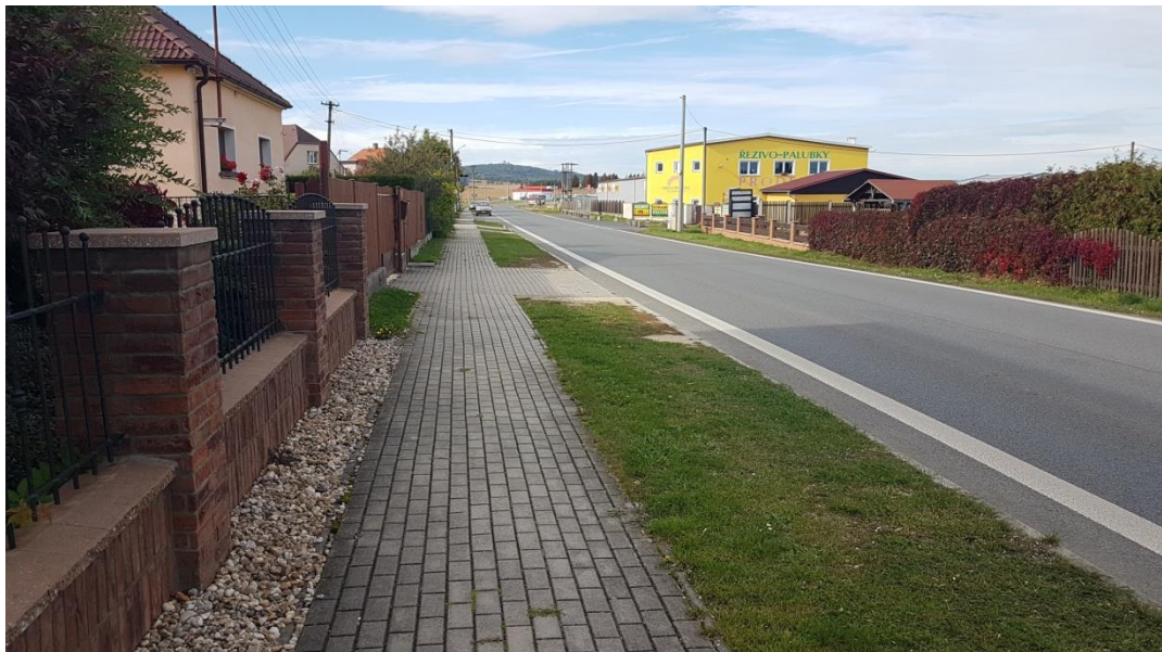
Obrázek 12: Stávající stav chodníku a vjezdu na soukromý pozemek směr Plzeň
