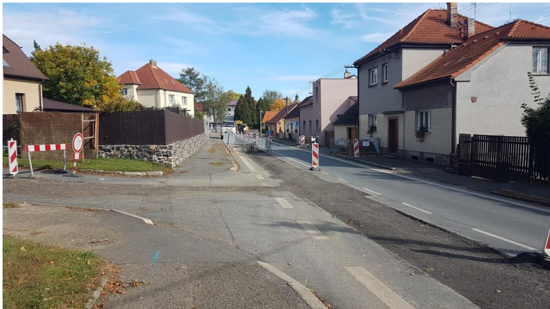
Obrázek 28: Současný stav chodníků a vozovky silnice I/19 směr Tábor
