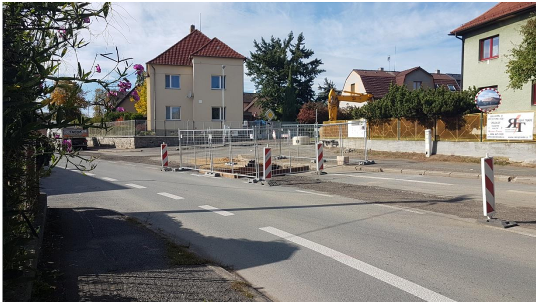
Obrázek 33:Prostor napojení místních komunikací na silnici I/19 směr Plzeň u mateřské školy Nezvěstice
