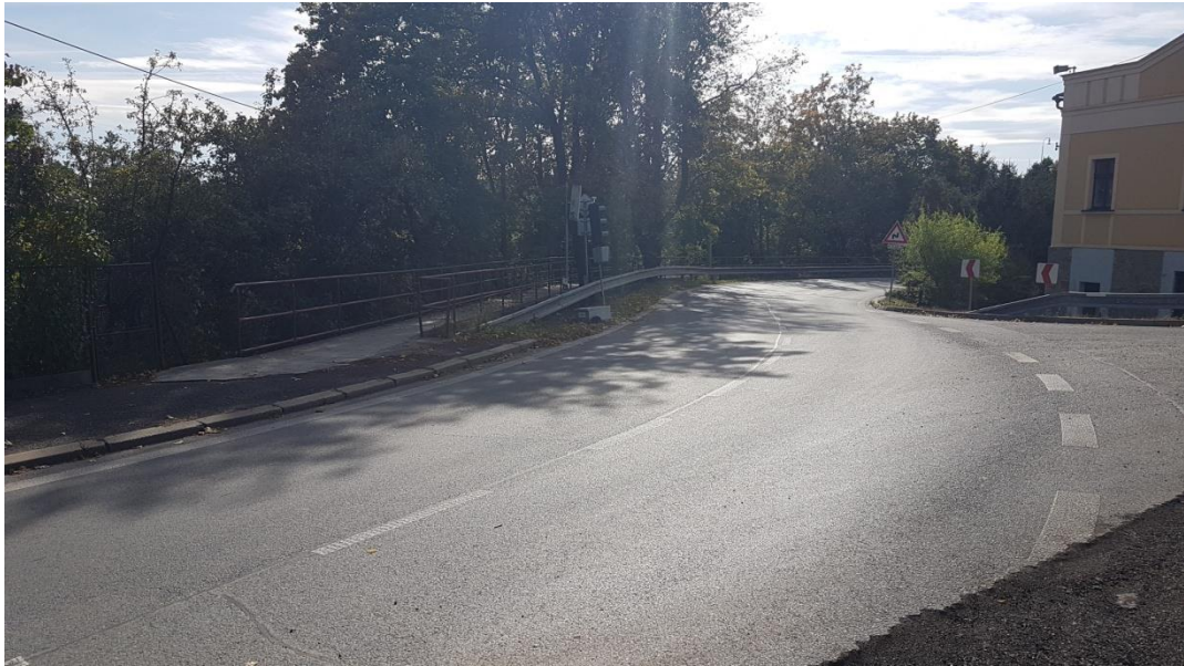
Obrázek 25: Pohled do směrového oblouku silnice I/19 směr Plzeň (začátek projektovaných úprav 2. úseku)
