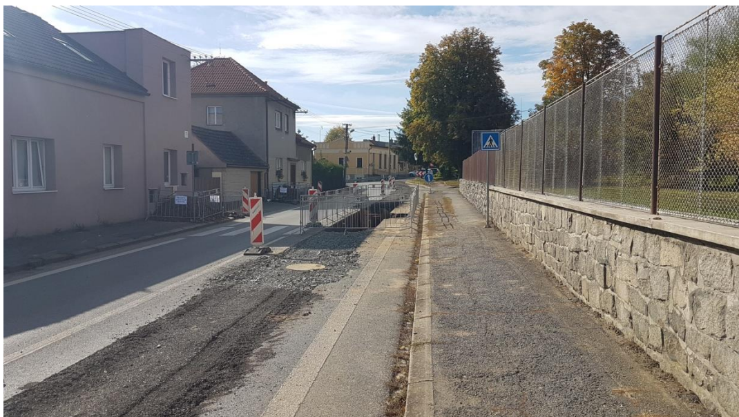
Obrázek 30: Současný stav chodníků a přechodu pro chodce směr Plzeň
