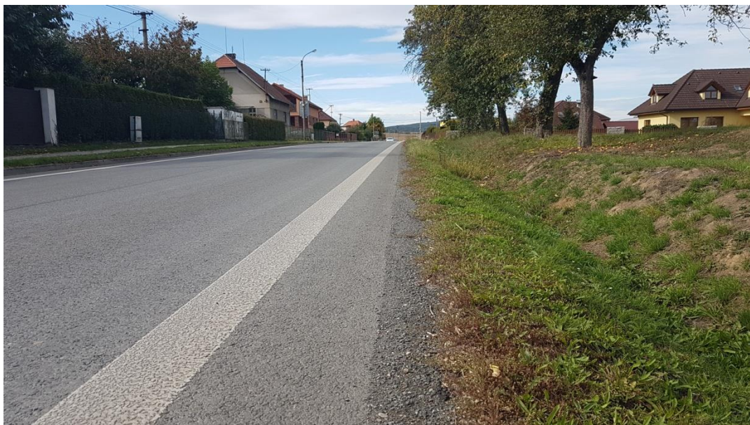
Obrázek 14: Detail pravé krajnice vozovky I/19 směr Plzeň (příčný profil s nezpevněnou krajnicí a příkopem)
