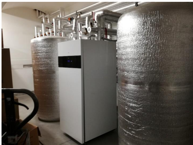
Obr.3 – Sestava tepelného čerpadla s akumulací nádobou na otopnou vodu a zásobníkovým ohřívačem TUV
