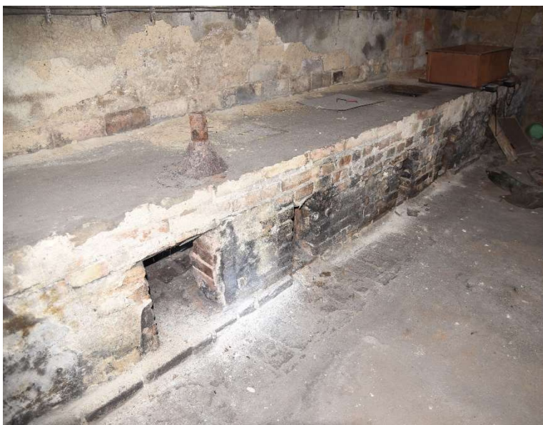
Obrázek 22: Pohled na kouřový kanál v kotelně
