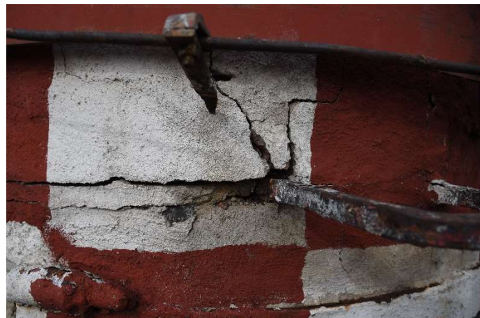
Obrázek 41: Korodující ukotvení stupadla
