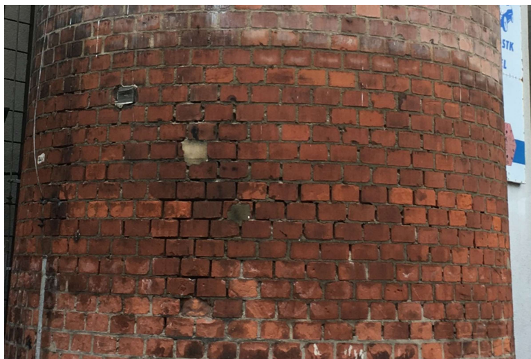
Obrázek 35: Vypadaná spárovka v oblasti vlhkého zdiva
