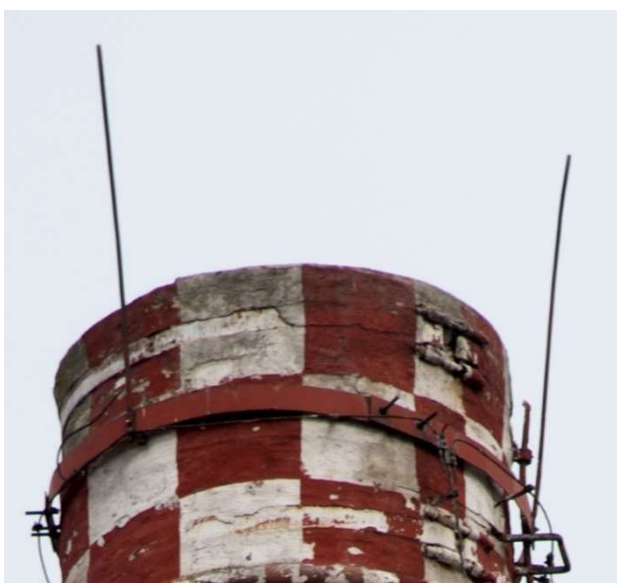
Obrázek 31: Bleskosvodné tyče a prstenec z pásové oceli
