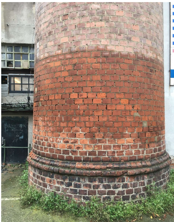
Obrázek 32: Viditelná hranice vlhkého zdiva
