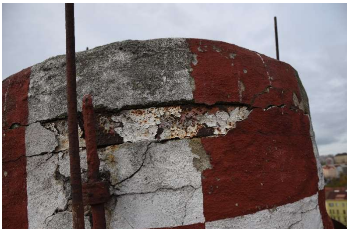
Obrázek 40: Koroze na obruči
