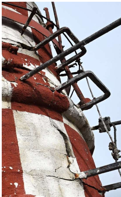
Obrázek 38: Trhliny na hlavici
