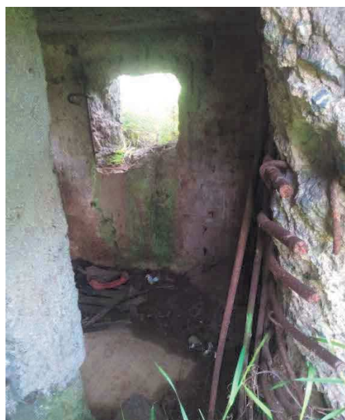
Obr. 125 Částečná destrukce obvodových stěn
