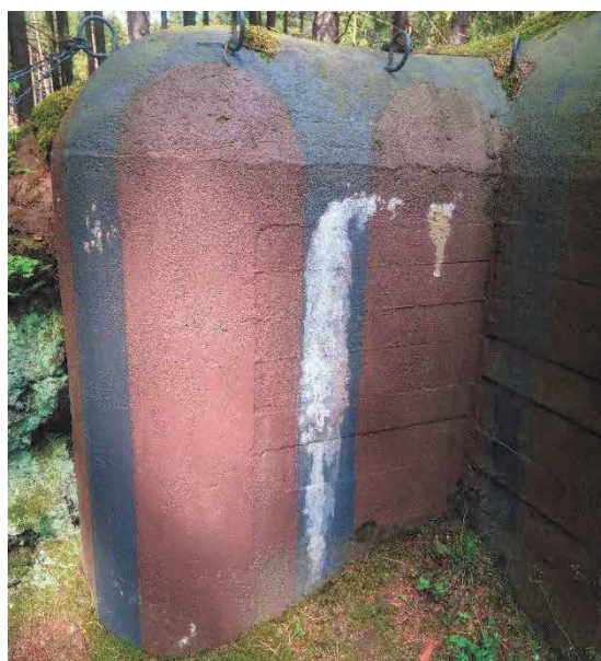
Obr. 115 Vápenný výkvět na objektu po rekonstrukci
