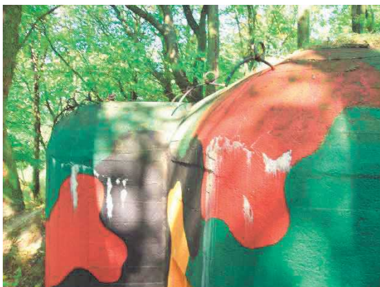
Obr. 53 Vápenné výkvěty vzniklé po rekonstrukci
