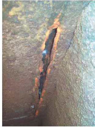
Obr. 59 Obnažená prutová výztuž
