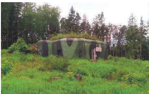
Obr. 95 Objekt LO vz.37 (9/1319/A-180) – zrekonstruován do stavu socialistické reaktivace. Bližší průzkum nebyl možný z důvodu oplocení objektu
