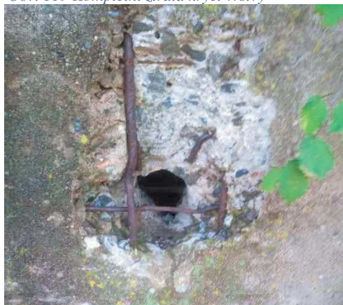
Obr. 121 Obnažená výztuž – mechanické poškození
