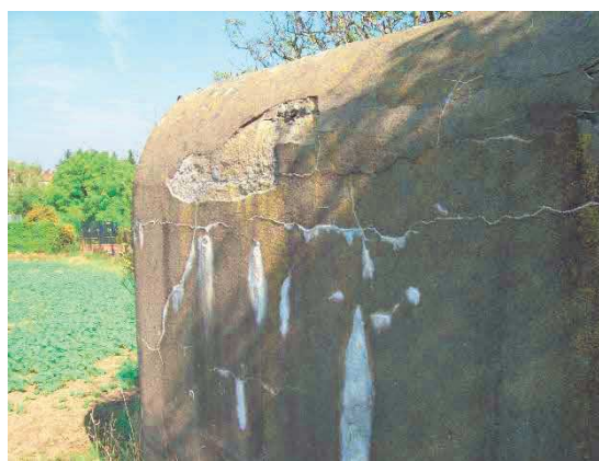
Obr. 48 Vápenné výkvěty, ztráta adheze omítky
