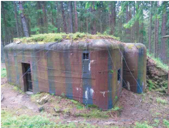
Obr. 82 Objekt LO vz.37 (9/1316/A-160) – vápenné výkvěty
