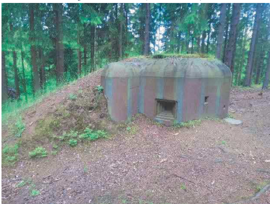
Obr. 86 a 87 Objekt LO vz.37 (1/1048/A-140) – vápenné výkvěty
