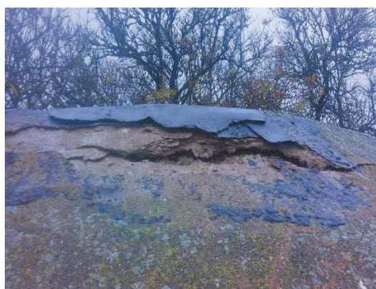
Obr. 46 Ztráta adheze krycí omítky pod hydroizolací
