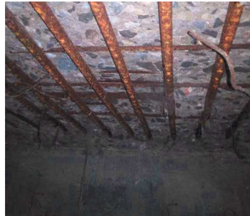
Obr. 119 Kompletní ztráta krycí vrstvy
