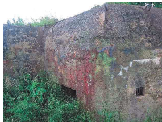
Obr. 99 Vápenné výkvěty na dochovaném objektu LO
