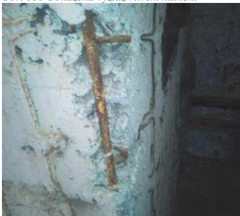
Obr. 120 Obnažení výztuže – mechanické poškození
