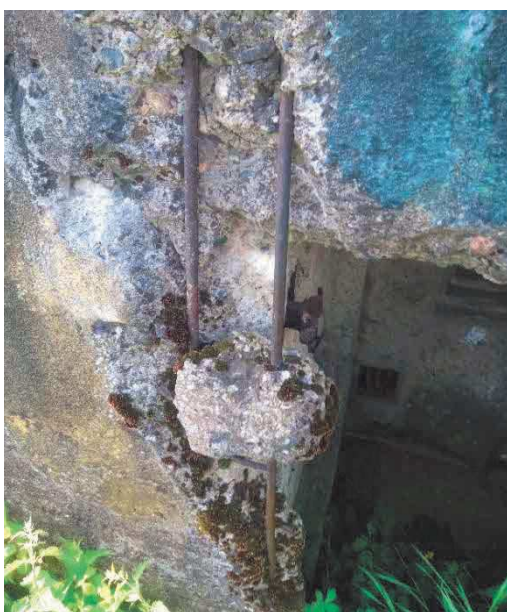
Obr. 124 Částečná destrukce čelní stěny u vstupu
