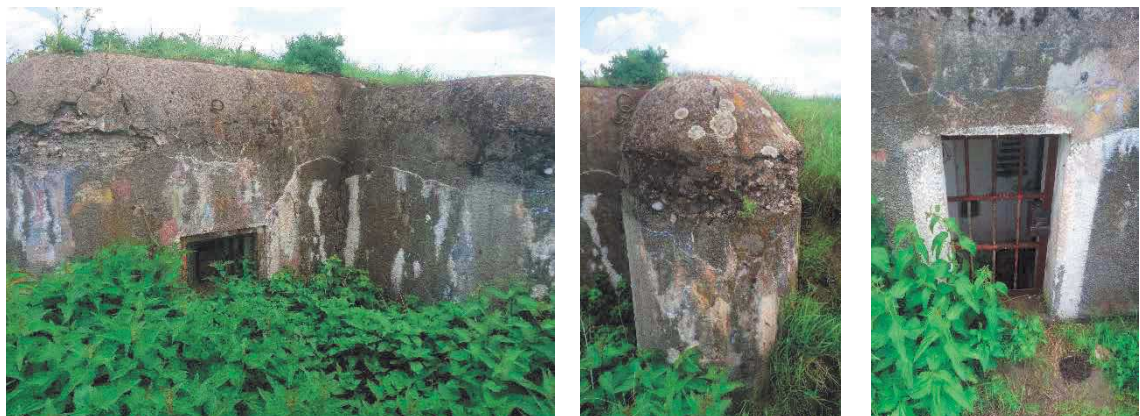
Obr. 109,110, 111 Dochovaný neudržovaný objekt LO vz. 37 (4/3077/D1) – poruchy omítky, vápenné výkvěty
