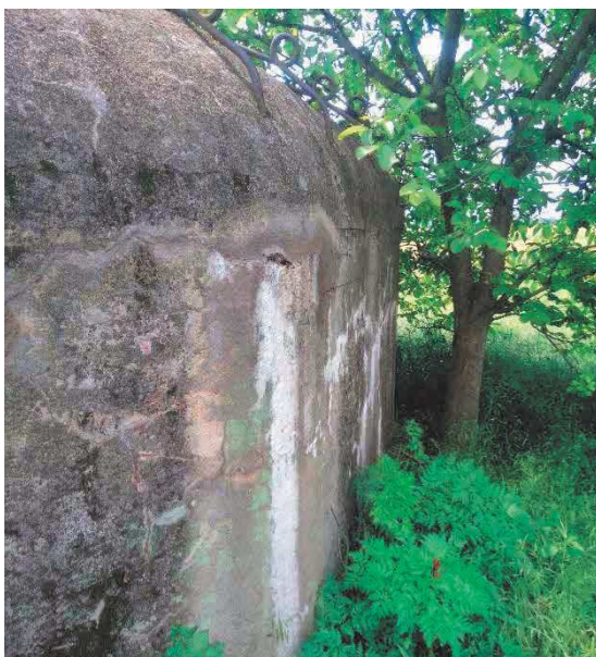
Obr. 114 Vápenný výkvět na objektu v původním stavu
