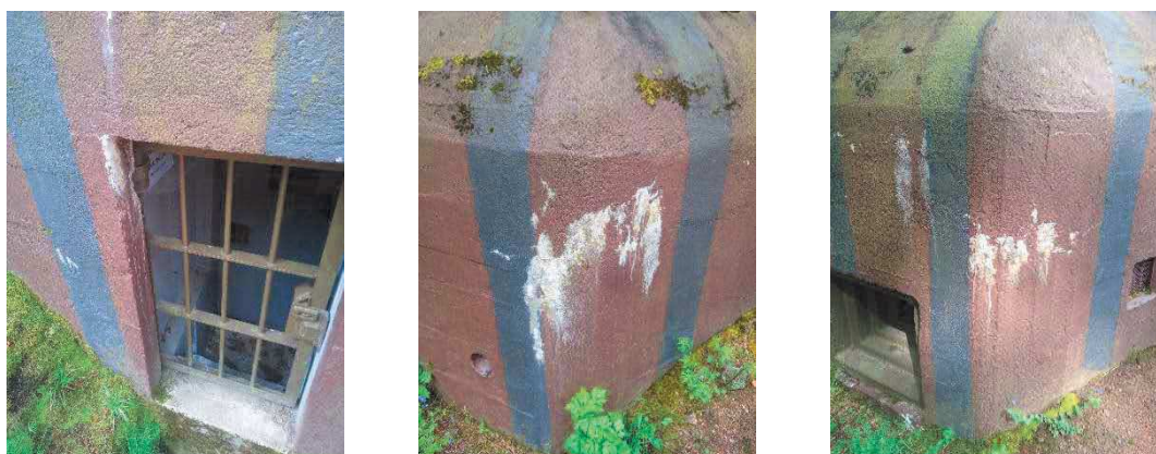
Obr. 77, 78, 79, 80, 81 Objekt LO vz. 37 (I/1049/A-120) – Vápenné výkvěty
