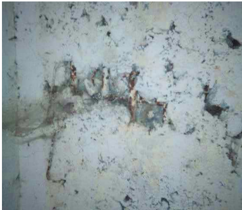
Obr. 118 Obnažená výztuž vlivem hutnění
