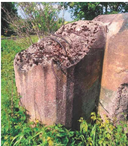
Obr. 122 Částečná destrukce tylové stěny
