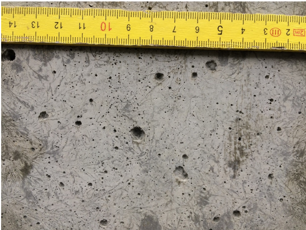
Obrázek 22 Poškození mrazem – žilkování při teplotě – 10 °C
