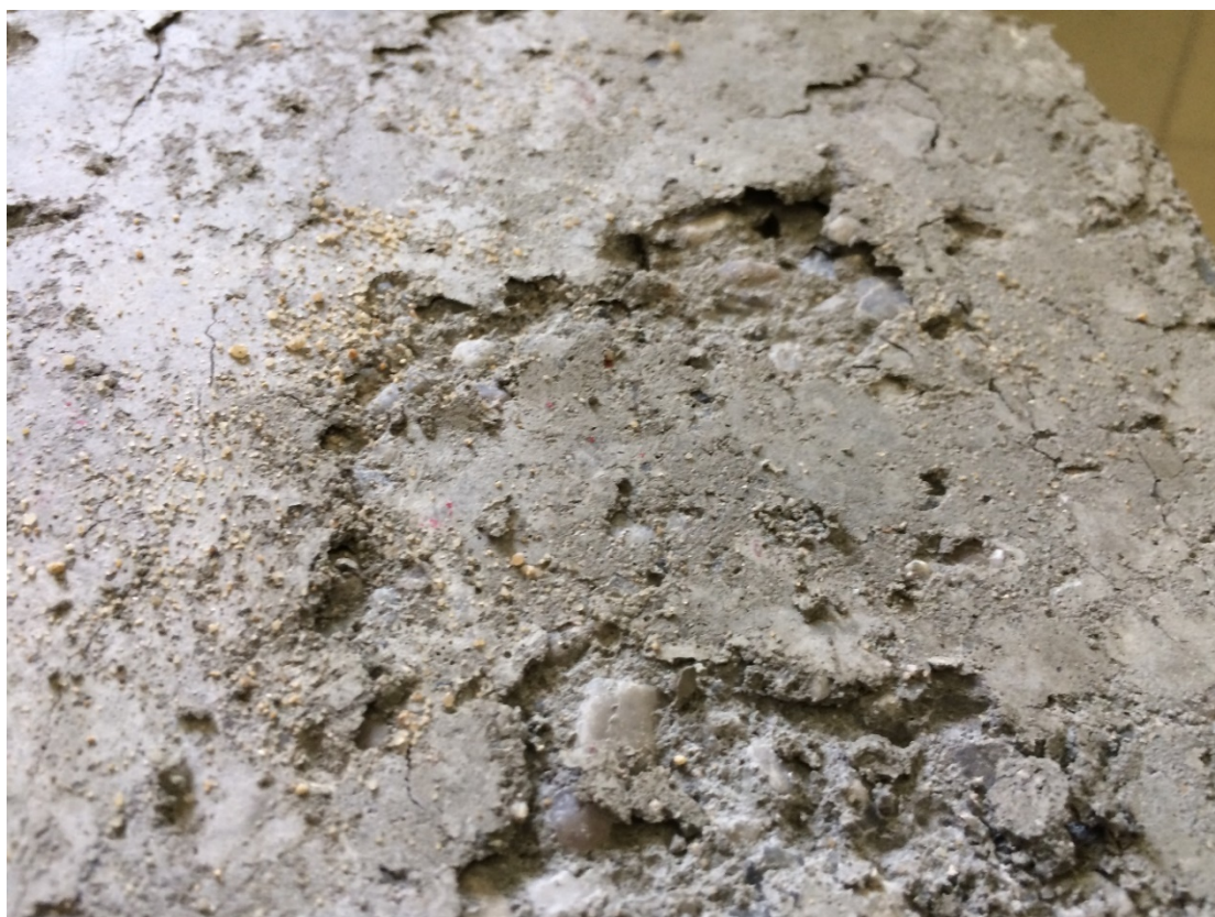
Obrázek 38 Detailnější poškození betonu po pěti dnech vystaveného v mrazu - 20 °C
