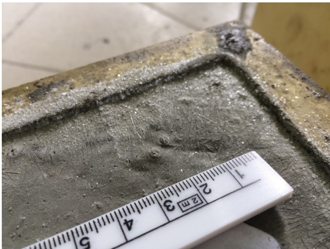
Obrázek 35 Poškození betonu po třech dnech vystaveného v mrazu - 15 °C
