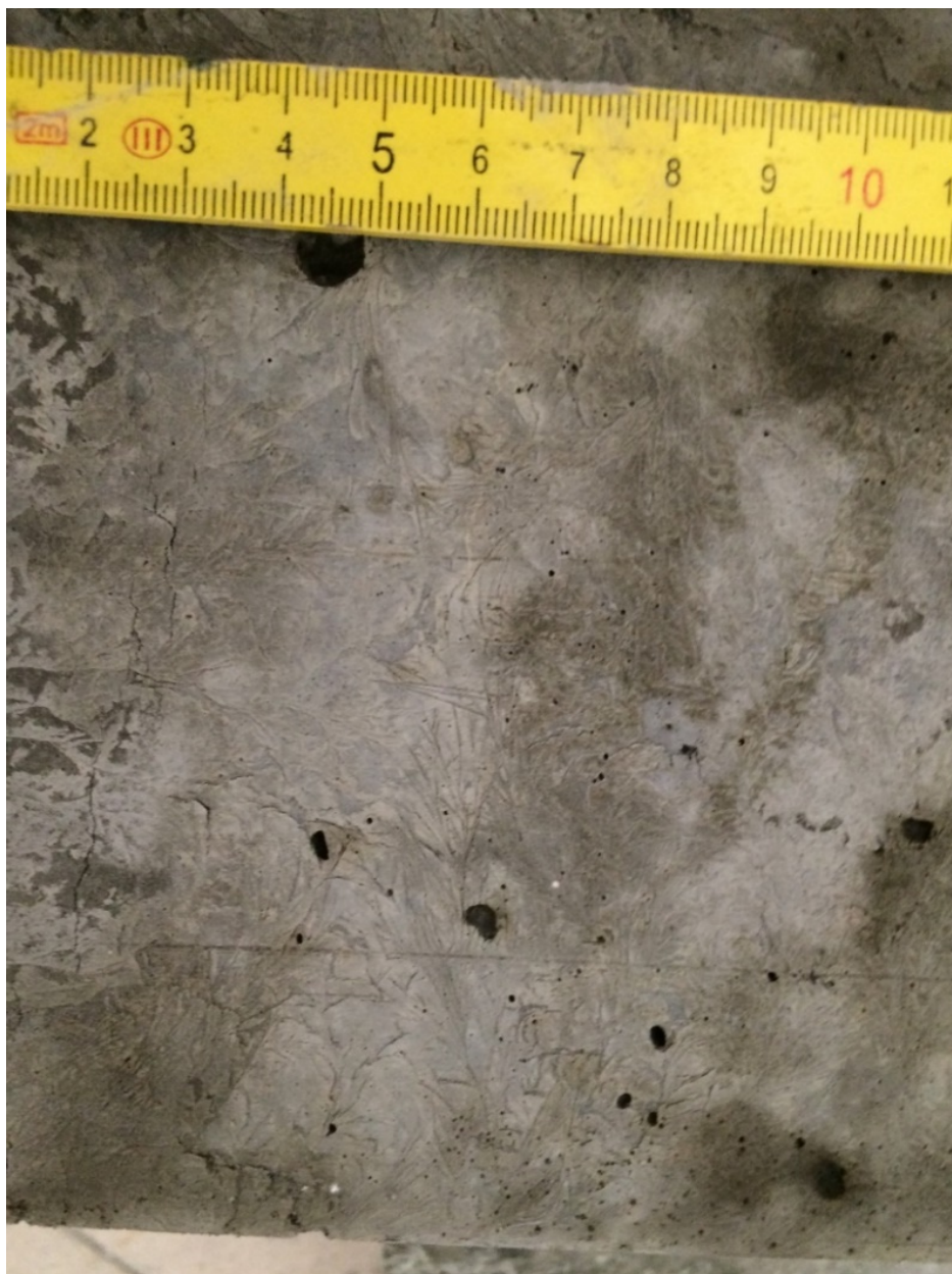
Obrázek 21 Poškození mrazem při teplotě – 10 °C
