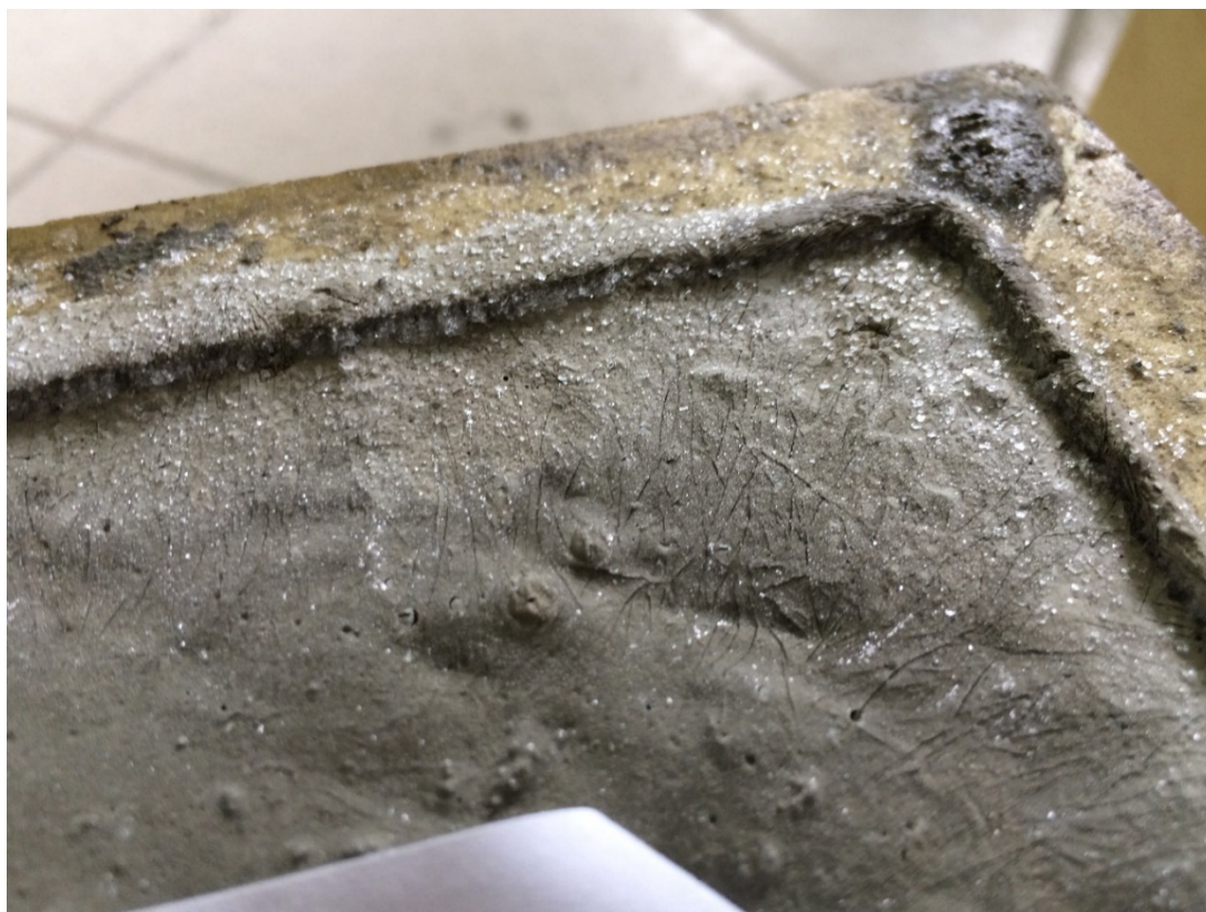
Obrázek 36 Detail poškození betonu po třech dnech vystaveného v mrazu - 15 °C
