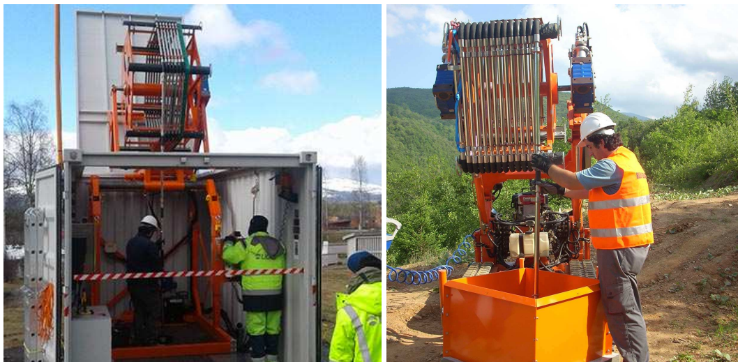
Obr. 2.5 Instalace senzoru DSM (CSG s.r.l. 2019): (vlevo) Instalace s použitím univerzálního kontejneru; (vpravo) Instalace pomocí speciálního pásového dopravníku
