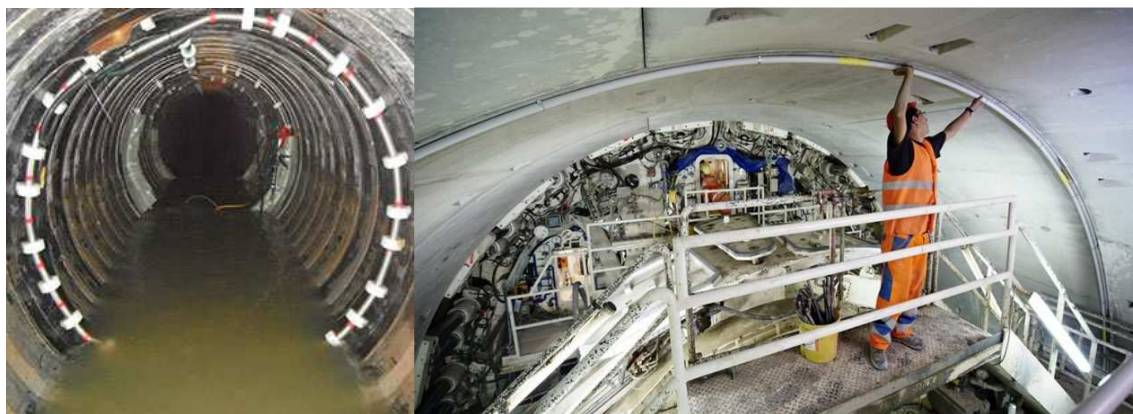
Obr. 3.5 Kombinovaná instalace senzoru SAA: (vlevo) Senzor instalovaný v kanalizační stoce (Measurand), (vpravo) Instalace senzoru SAA do ostění tunelu ve Švýcarsku (Meyer a Schütz 2011)
