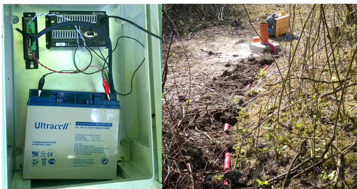
Obr. 5.13 Senzor instalovaný na lokalitě v Třebenicích: (vlevo) elektroinstalační box; (vpravo) vrt s vyvedenou chráničkou
