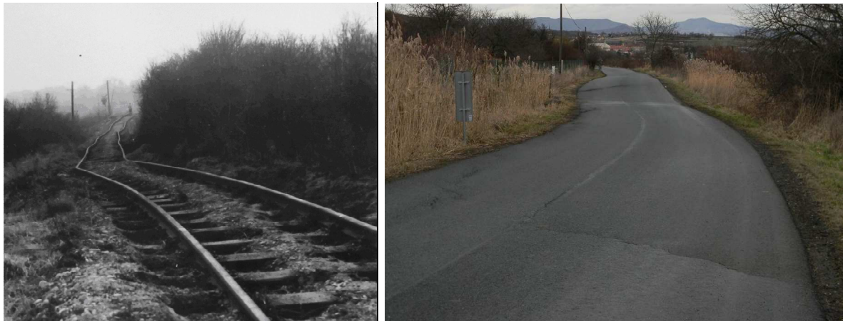
Obr. 5.2 Projevy svahových deformací na lokalitě u Třebenic: Destrukce trati následkem reaktivace sesuvu v roce 1981 (Rybář 1983); deformace silniční komunikace zřetelně vymezená trhlinami v asfaltovém povrchu 2016
