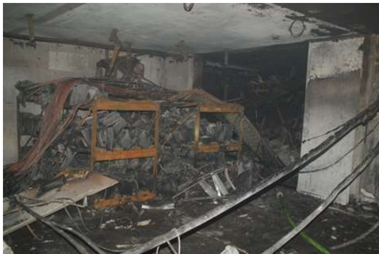
Obrázek 14 - Požár ve výpočetním centru banky [19]
