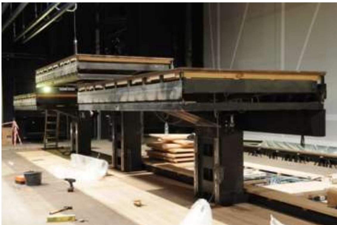
Obrázek 12 Jevištní technologie - primární hydraulické stoly [2]
