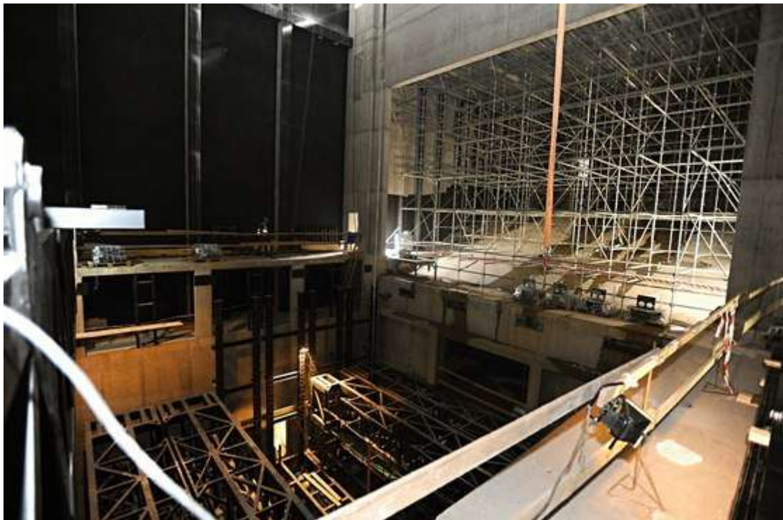
Obrázek 13 Jevištní technologie - pohled na hlavní jeviště [9]
