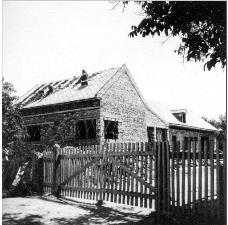
Obr. 1: Vinné (okr. Michalovce) č. 607, pokrývačské práce na hrubej stavbe vinkľového domu (foto J. Staňková 1953).
