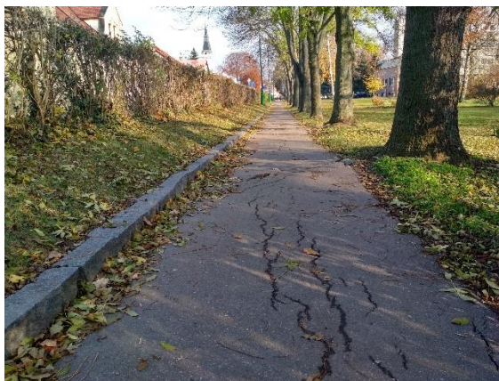
Obr. 29 – Pohled na úsek komunikace s porušeným povrchem (K1.10)
