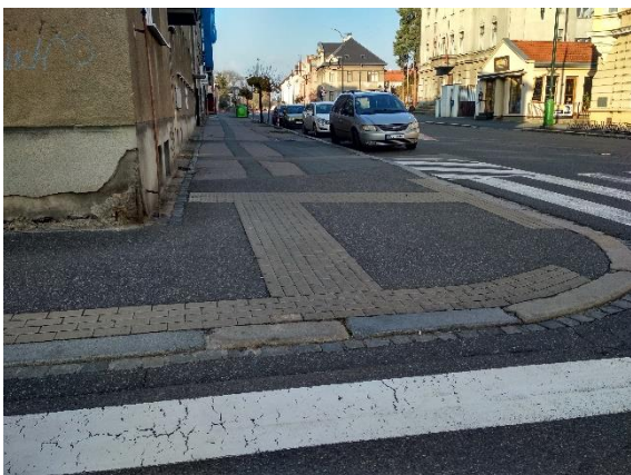
Obr. 21 – Počáteční strana přechodu P1 – chybné napojení signálních pásů
