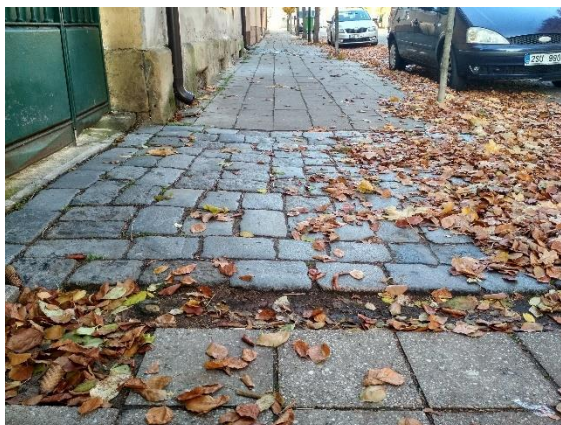
Obr. 42 – Spára za vjezdem vozidel (K3.1)
