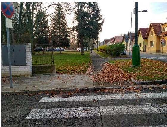
Obr. 41 – Chybějící vodící linie na začátku komunikace (K2.8)
