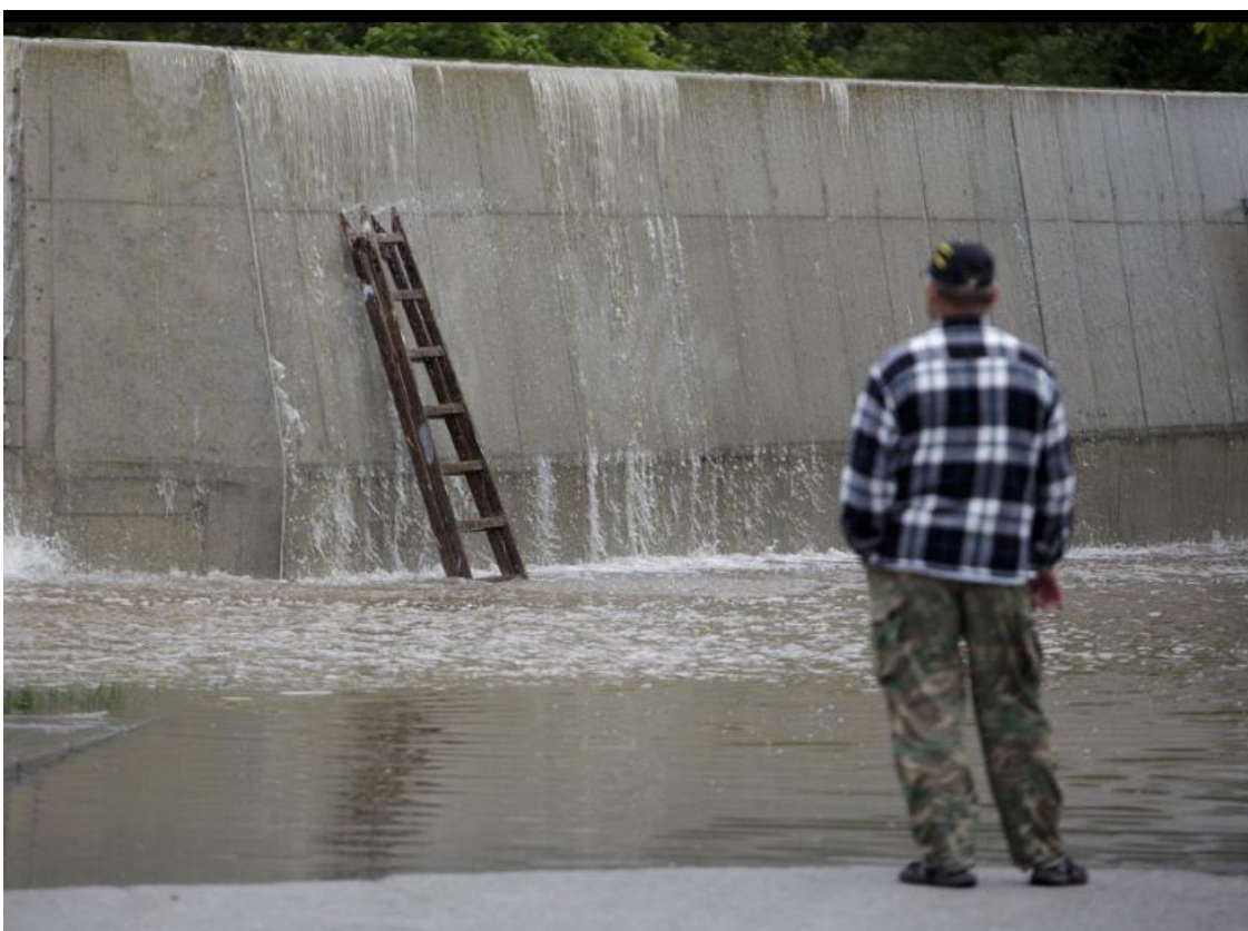
Foto 18 - Protipovodňová zeď v Hoříně při povodni roku 2013. Zdroj: https://www.denik.cz/galerie/povodne-cesko-zaplavy-040613.html?photo=67&mm=4527775
