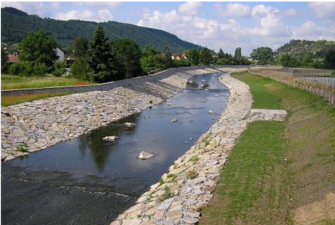
Foto 5 - Litavka v Popovicích u Králova Dvora, 2009. Nevhodná technická úprava koryta, která devalvuje pobytovou i ekologickou hodnotu. Zdroj: http://www.4stav.cz/protipovodnova-opatreni-na-rece-litavce-v-kralovem-dvore-u-berouna_4c3825
