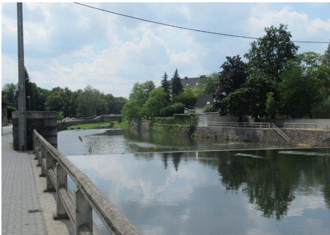
Foto 14 - Vpravo protipovodňová zeď částečně obrostlá břechtanem a přístup k řece. Choceň, 2019. Foto: autor.
