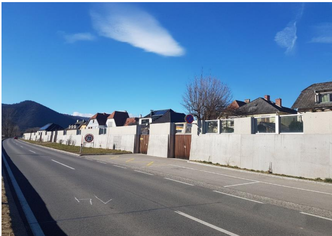
Foto 20 - Protipovodňová zeď na plnění funkce plotu. Horní díly jsou částečně prosklené. Wachau, Rakousko. Foto: autor.
