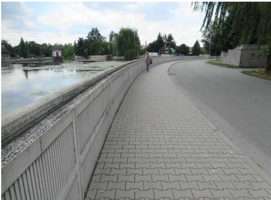
Foto 15 - Protipovodňová zeď s profilací a madlem. Choceň, 2019. Foto: autor.
