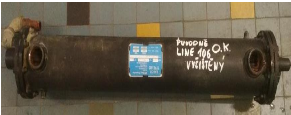
Obr. 1. Čištěné chladicí zařízení.
