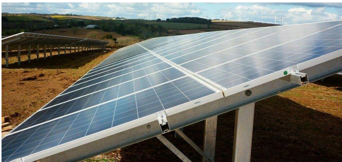
Obr. 1. Pohled na fotovoltaickou elektrárnu [1].
