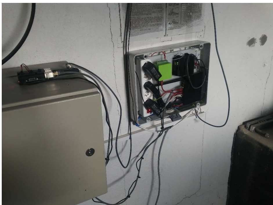
Obrázek 33: Výsledná podobna instalace zařízení (zdroj: autorův archiv).
