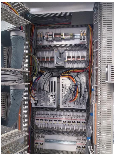
Obrázek 29 - Vnitřní část rozvaděče
