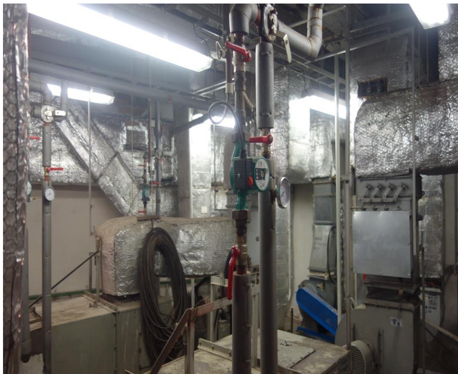
Obr. 3.2 Nefunkční rozvody otopné vody
