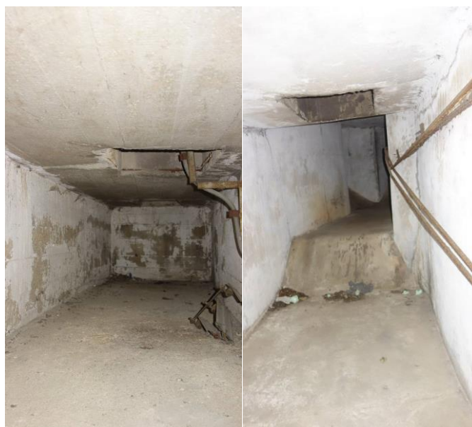
Obr. 3.7 Vnitřní betonový kanál pro centrální přívod vzduchu
