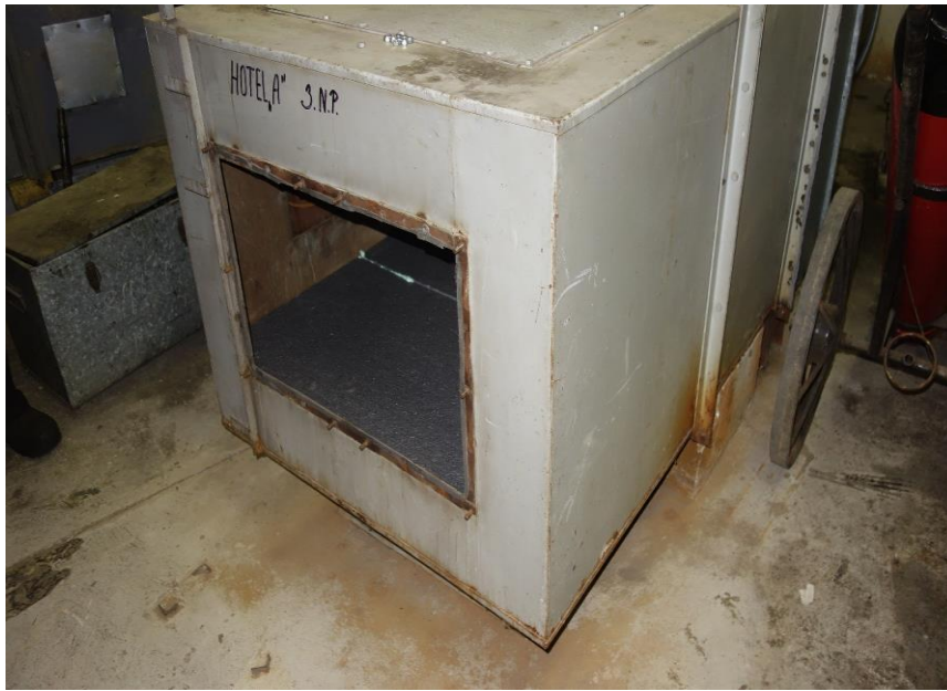
Obr. 3.4 Sání vzduchu z technické místnosti (zakrytý přívod venkovního vzduchu)
