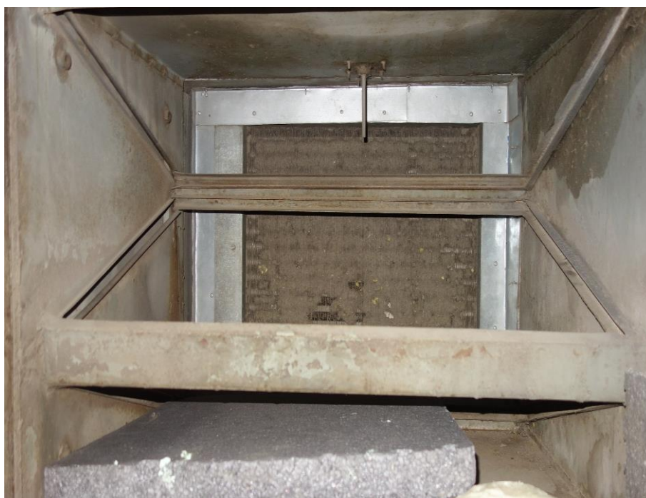
Obr. 3.3 Zanesený teplovodní výměník (chybějící filtrace)
