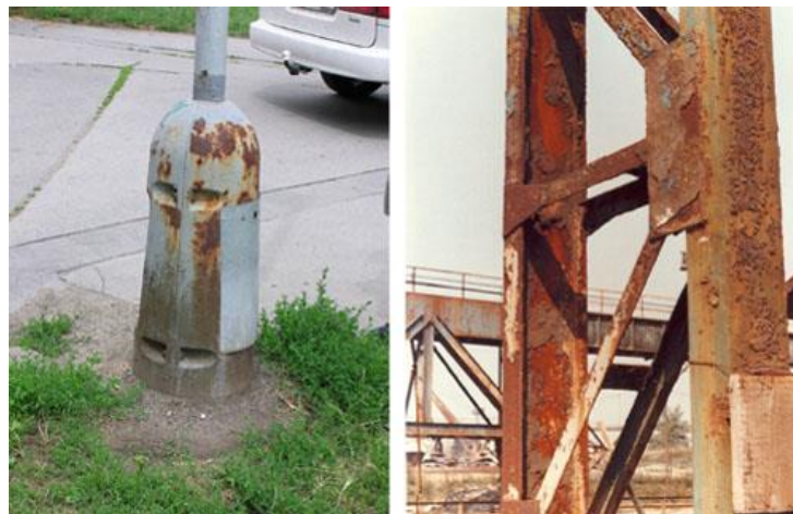
Obrázek 2 - Napadení atmosférickou korozí [36]
