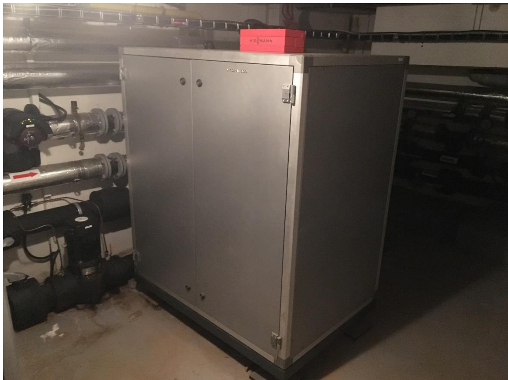
Obr. 4-3 Tepelné čerpadlo Viessmann 300-G PRO umístěné v suterénu budovy MFF UK
