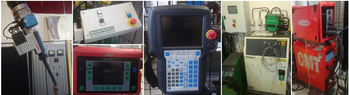
Obr. 6.2 - Prvky pracoviště (zleva: hořák RA280 CMT, kontrolní panel, RCU 5000i, Teach pendant, PLC a řídicí jednotka Fanuc R-J3i C, svařovací zdroj TPS 3200 CMT s podavačem VR 7000 CMT)
