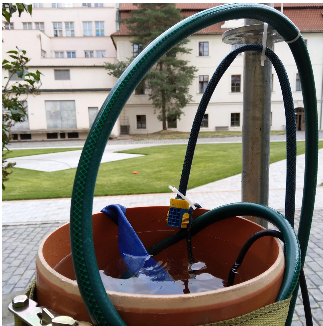
Obrázek 69: Detail přívodu vody z řadu a zpětné větve do nádrže ve které je ponořeno čerpadlo
