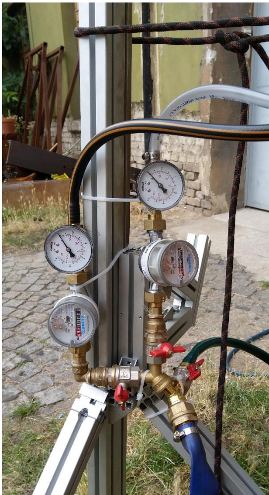
Obrázek 67: Detail regulačních a měřicích zařízení
