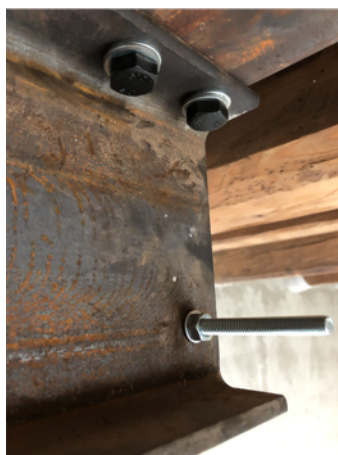
Obr 3.18 Doraz pojezdového nosníku [Autor]
