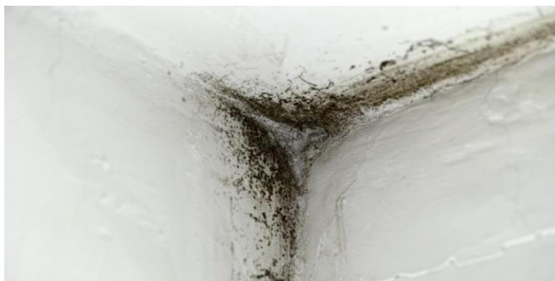
Obrázek 15: Kondenzace vodních par v interiéru v důsledku tepelného mostu [26] https://www.termotech.cz/wp-content/uploads/2018/03/484869598_XS-1200x600.jpg
