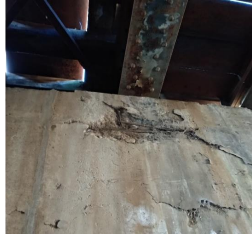
Obr. 15: Zvětrání betonu na opěře O2
