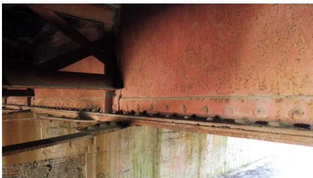
Obr. 13: Korodování nosné konstrukce (pohled z kraje opěry O1)
