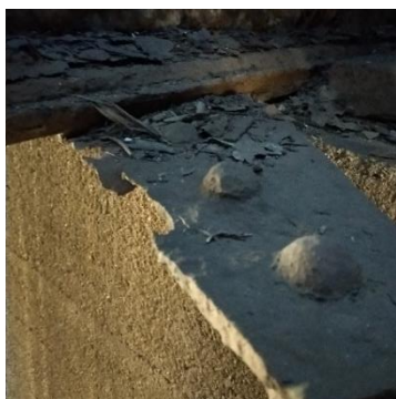
Obr. 12: Oslabený styčnickový plech u opěry O2
