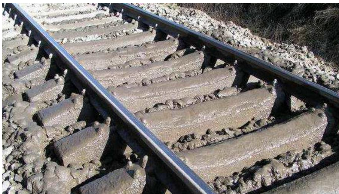
Obr. 5.3 - Pohled na zablácené místo ve zkušebním úseku v Blovicích (03/2008) [19]
