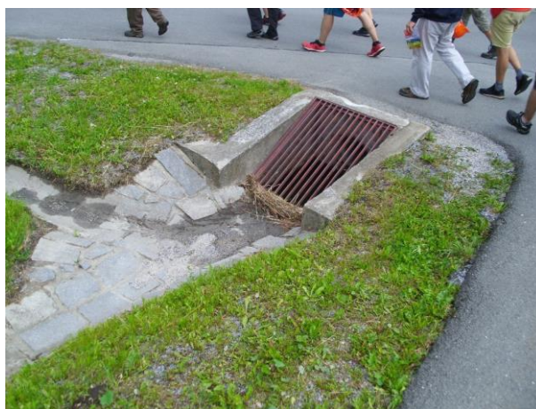
Obr. 8: Česle sloužící k předčištění dešťového odtoku [31]
