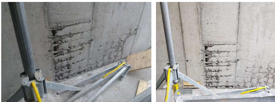
Obrázek 70,71: Místo poruchy – Štěrkové hnízdo s kavrou a obnaženou výztuží
