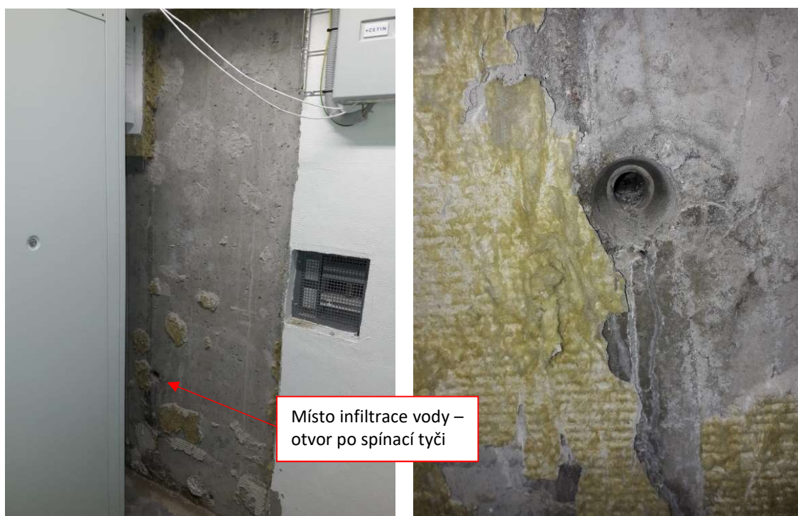
Obrázek 66 (vlevo): Místo poruchy zbavené kompletačních konstrukcí Obrázek 67 (vpravo): Místo infiltrace vody – otvor po spínací tyči
