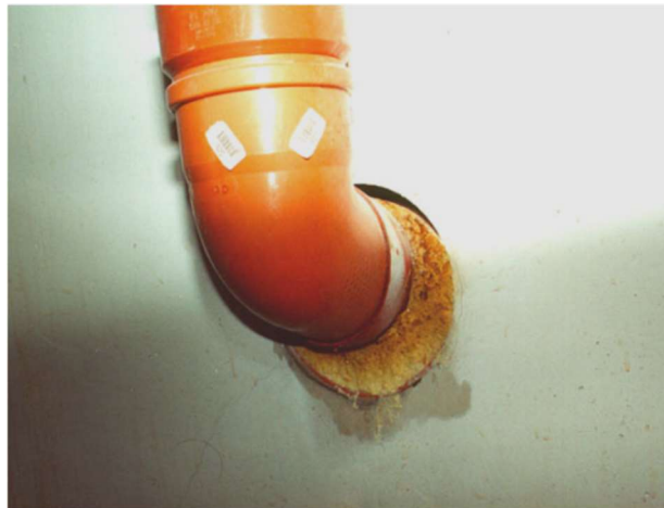
Obrázek 61: Poruchové místo – infiltrace vody podél prostupu TZB
