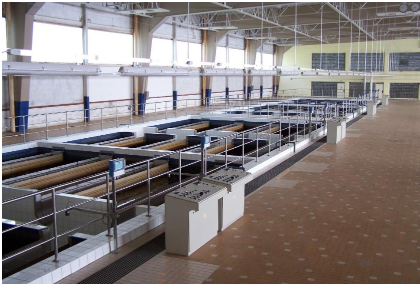
Obrázek 10- Filtrační nádrže na ÚV Hradiště [23]
