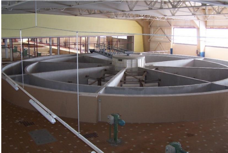
Obrázek 9 - Reakční nádrž na ÚV Hradiště [23]
