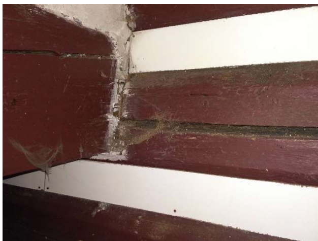
Obrázek 3.38 Pohled na trhliny trámů (zdroj: vlastní foto)
