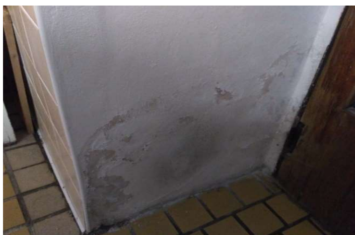
Obrázek 3.21 Vzlínající vlhkost v kuchyni (zdroj: vlastní foto)
