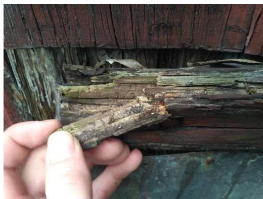
Obrázek 3.20 Degradace dřevěného obkladu štítu (zdroj: vlastní foto)
