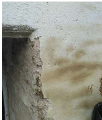
Obrázek 3.22 Pohled na stěnu zasaženou plísní (zdroj: vlastní foto)
