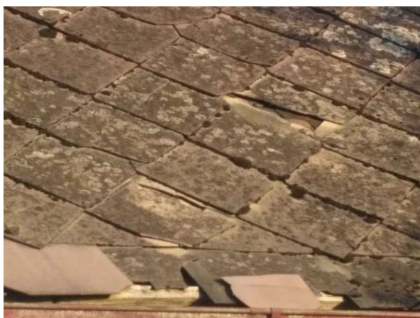
Obrázek 3.18 Popraskaná krytina (zdroj: vlastní foto)
