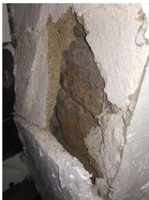
Obrázek 3.32 Odpadaná omítka v interiéru (zdroj: vlastní foto)
