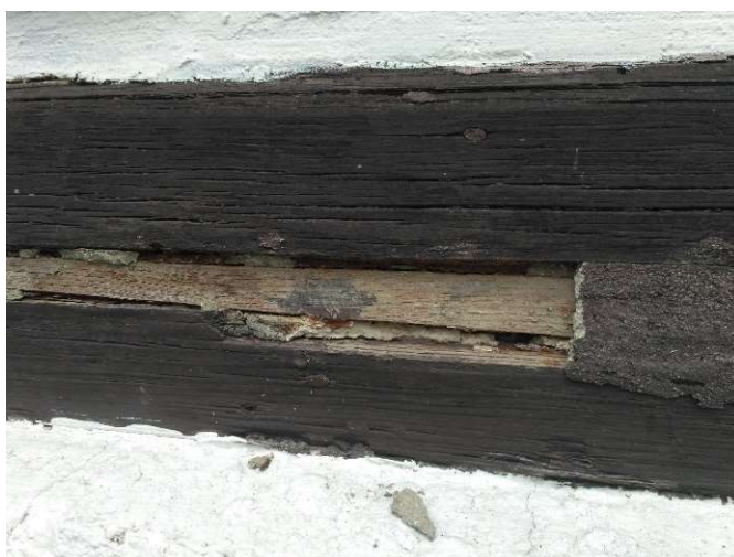
Obrázek 3.13 Pokus o vytmelení praskliny (zdroj: vlastní foto)
