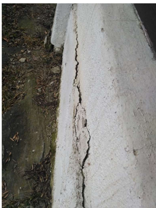
Obrázek 3.31 Trhlina soklu způsobená vlhkostí (zdroj: vlastní foto)
