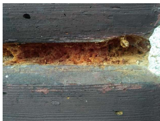
Obrázek 3.36 Zničená vysprávka spáry provedená montážní pěnou (zdroj: vlastní foto)
