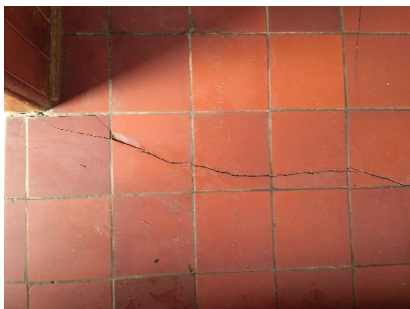
Obrázek. 3.17 Prasklina v podlaze (zdroj: vlastní foto)
