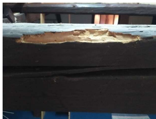
Obrázek 3.19 Porušení hambalku dřevokazným hmyzem (zdroj: vlastní foto)
