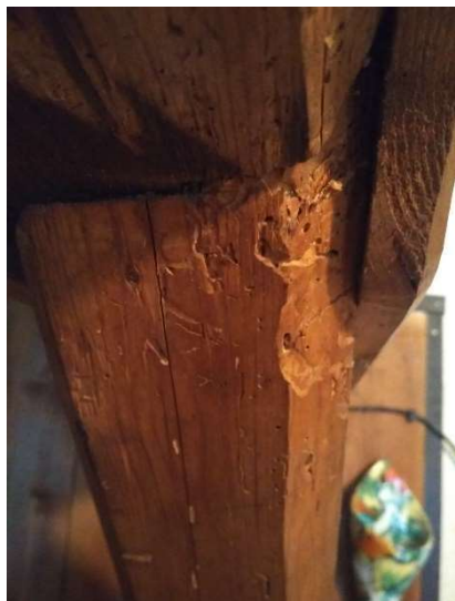
Obrázek 3.37 Pásek krovu s lehkým porušením (zdroj: vlastní foto)
