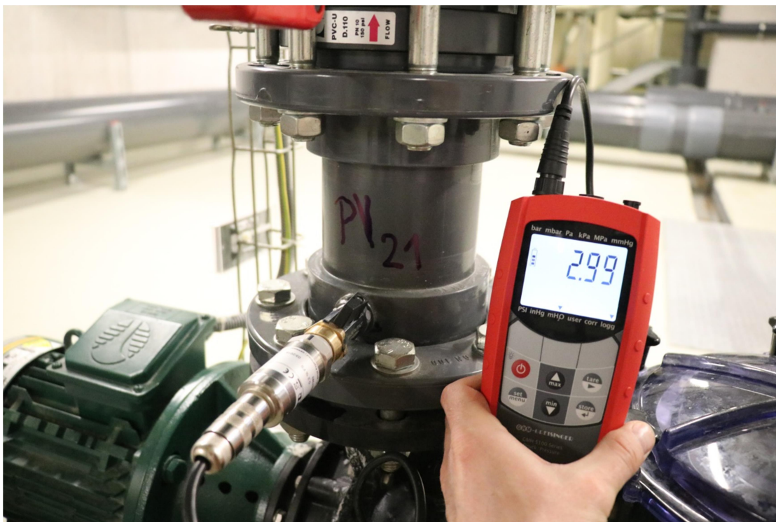
Obrázek 19. Měření tlaku za čerpadlem (přístroj Greisinger GMH5155 a sonda Greisinger MSD-1/3 BRE)
