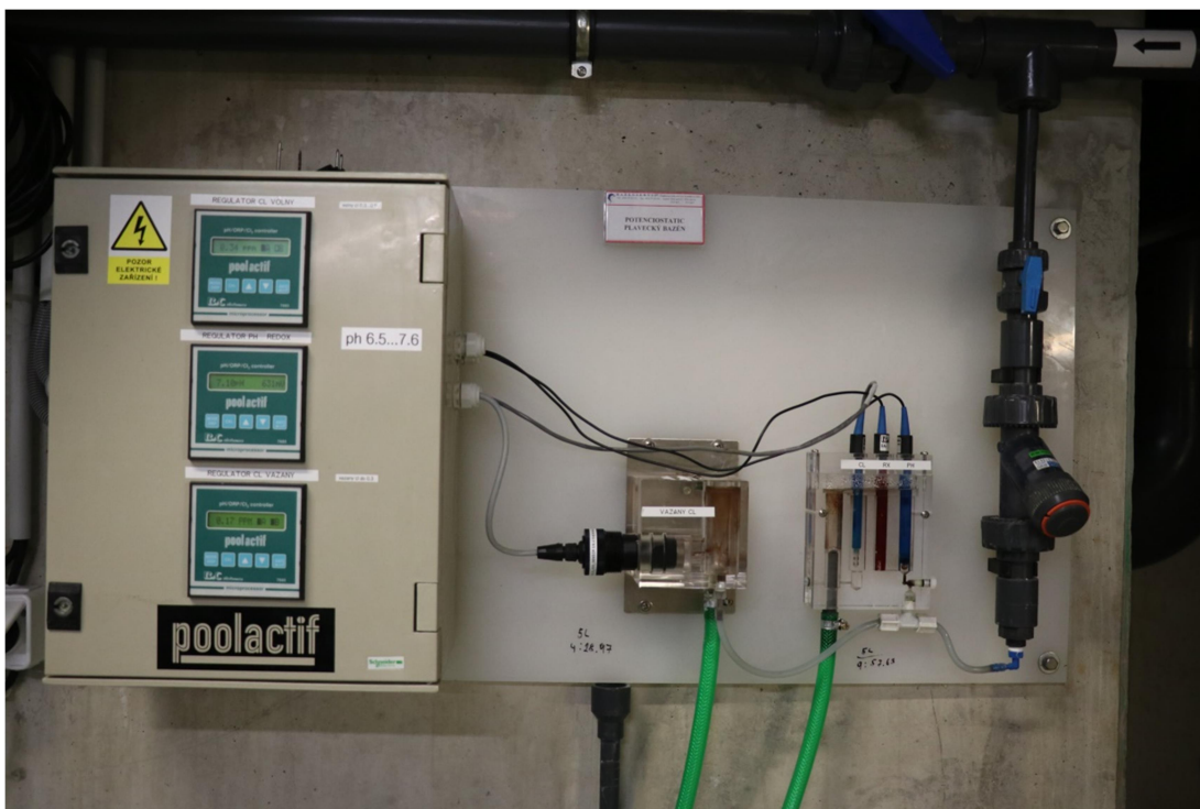
Obrázek 15. Měřicí a regulační jednotka (plavecký bazén)
