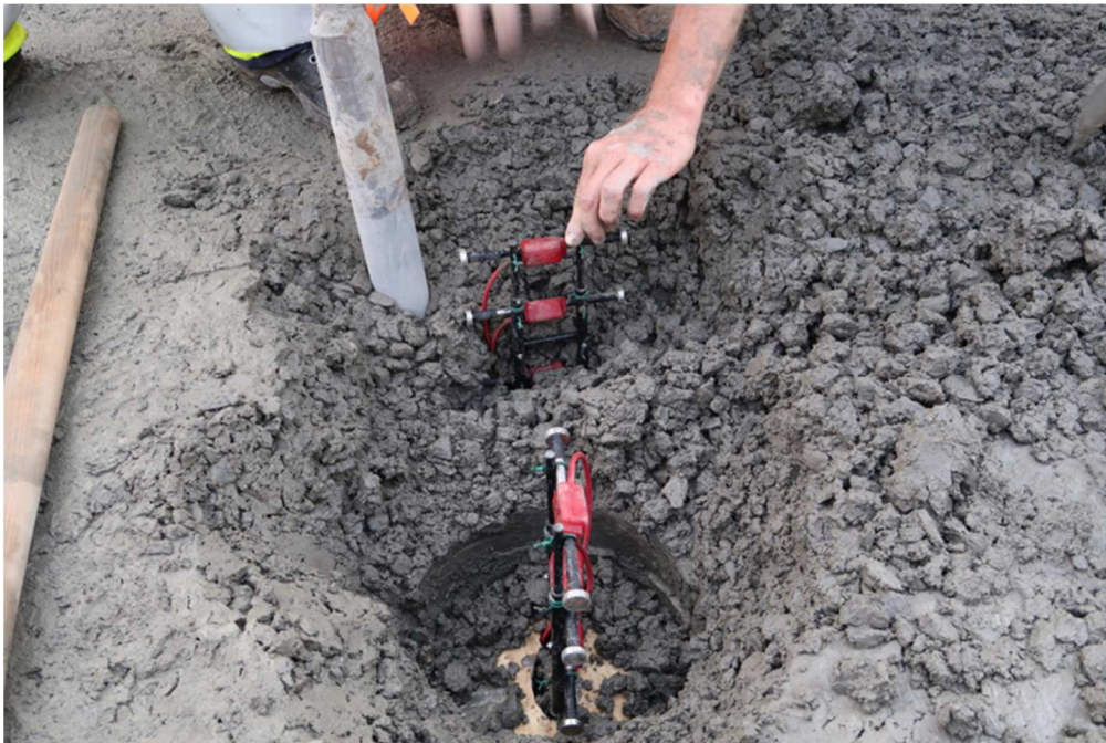
Obr. 39: Umístění čidel do správné polohy po přejezde 1. finišeru po odstranění ochranných „hrnců“ (foto S. Šulc)
