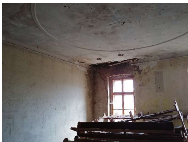
Obrázek 44: Viditelný průhyb dřevěné trámové stropní konstrukce, vznik trhlin, kolaps části konstrukce
