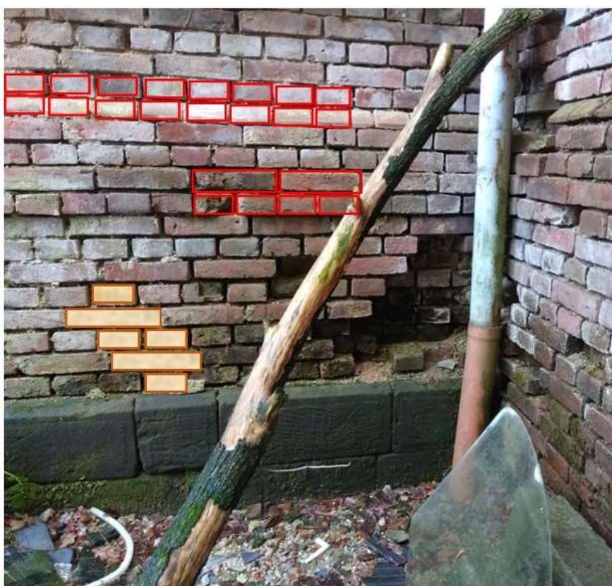
Obrázek 40: Znárodnění křížové vazby a špatně provedené vazby na severní obvodové zdi objektu
