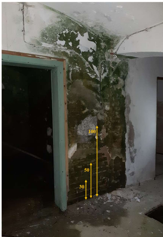
Obrázek 64: Místo odběru vzorku E ve třech výškových úrovních, zděná příčka suterénu
