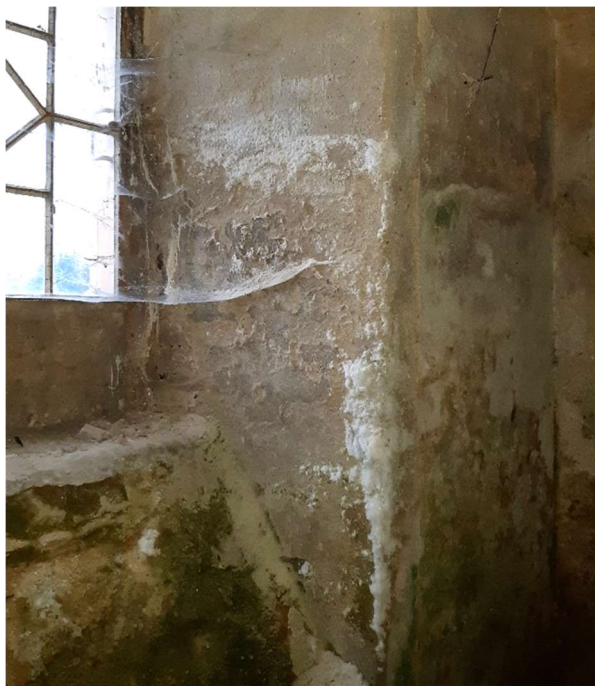
Obrázek 71: Zkrystalizovaná sůl na ostění okna suterénu
