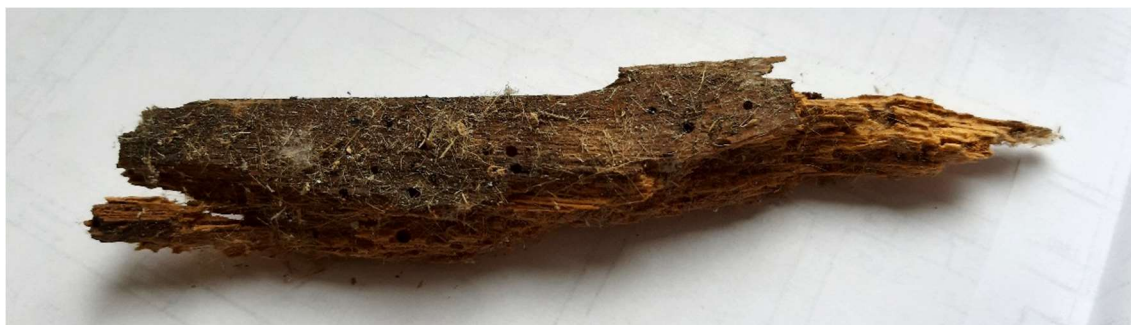
Obrázek 49: Odebraný vzorek z prostoru podkrovní s jasně viditelnými výletovými otvory způsobené dřevokazným hmyzem – červotočem
