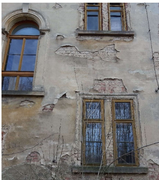
Obrázek 69: Odpadávání omítek na severní fasádě objektu
