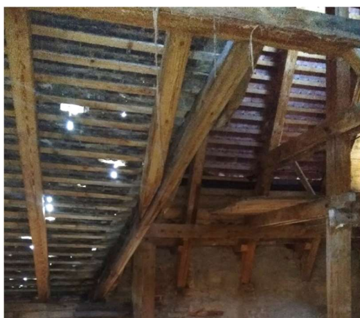
Obrázek 47: Porušení střešní krytiny na jižní straně objektu nad jeho středovým křídlem
