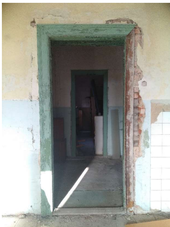
Obrázek 22: Nadpraží dveřního otvoru tvořeno dřevěnými fošny a vyzděným rovným překladem z cihel plných pálených
