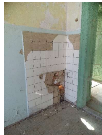
Obrázek 57: demontované umyvadlo, narušená omítka
