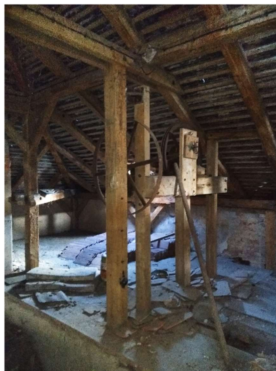
Obrázek 27: Strojovna nákladního výtahu umístěná v podkroví objektu
