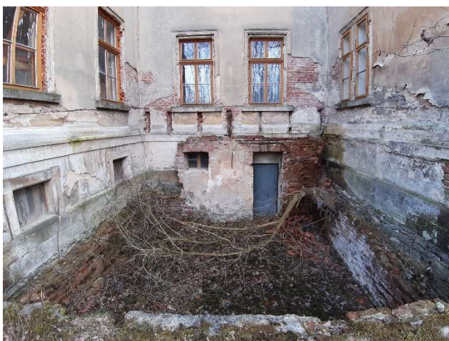
Obrázek 95: Vyšší rostliny degradující severní fasádu objektu
