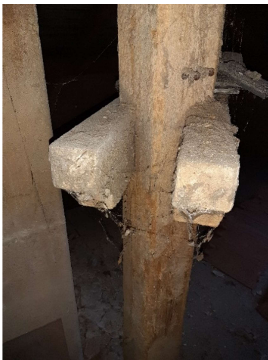
Obrázek 50: Detail narušení povrchové struktury dřeva tzv. rozvlákněním způsobené aplikací protipožárního nástřiku
