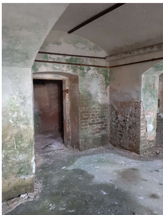
Obrázek 58: Vlhkostní mapy na svislých i vodorovných konstrukcích a zřejmé působení biologických degradačních procesů
