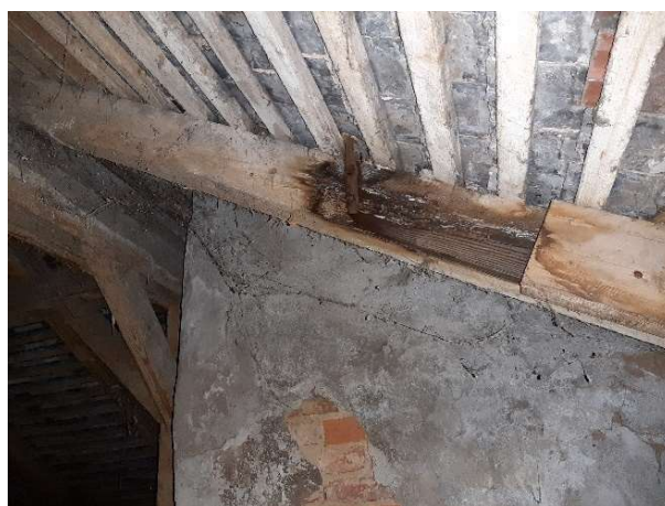
Obrázek 48: Narušení krokve vlivem zvýšené vlhkosti a koroze použitých železných prvků krovu
