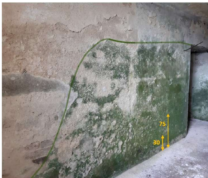
Obrázek 65: Místo odběru vzorku B ve dvou výškových úrovních - nosná svislá stěna ze smíšeného zdiva
