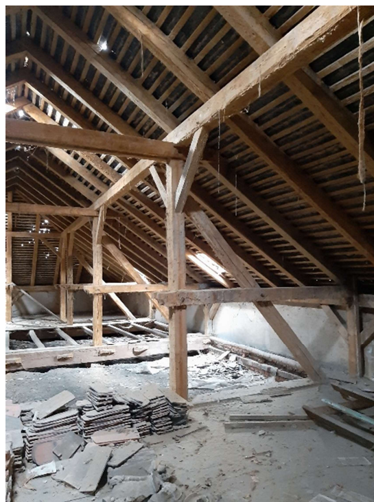
Obrázek 32: Tesařský spoj kleštin, vzpěry, pásků a vaznice se sloupkem, osedlání vaznic krokviemi a spojení krokví na ostřih
