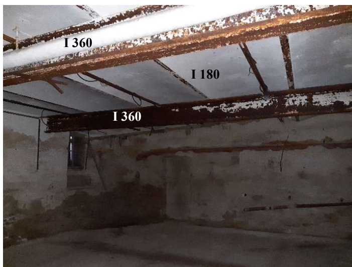
Obrázek 43: Značná koroze ocelových travers kleneb suterénu
