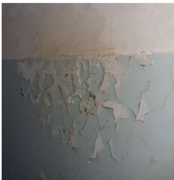
Obrázek 70: Narušení vnitřní omítky vlivem působení zvýšené vlhkosti
