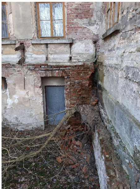
Obrázek 41: Nejvíce narušená část zdiva obvodové zdi na severní straně objektu
