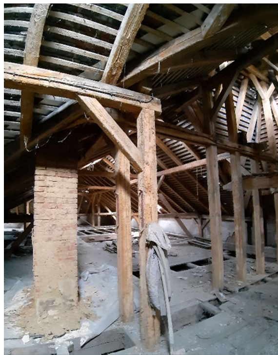
Obrázek 51: Neodborný zásah do nosné konstrukce vaznicové soustavy – uříznutí středové vaznice
