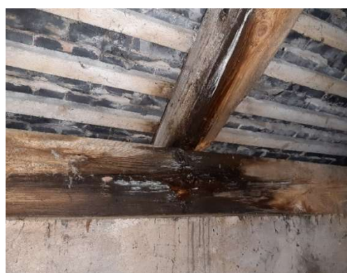
Obrázek 63: Okapová vaznice zasažená zvýšenou vlhkostí
