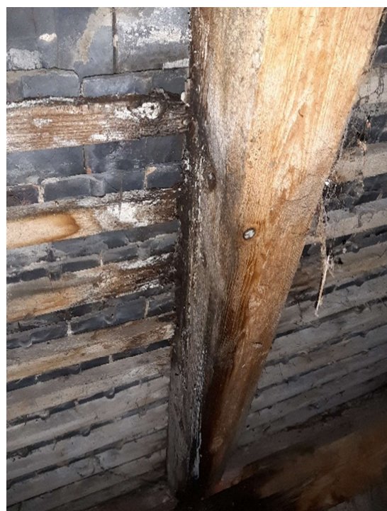
Obrázek 59: Dřevěné prvky krovu narušené vlhkostí a sní spojenými degradačními procesy
