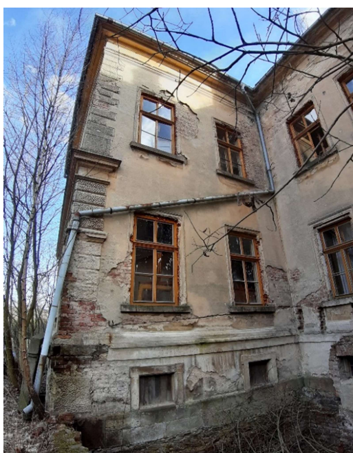
Obrázek 68: Narušený dešťový svod z něhož proniká dešťová voda a smáčí tak povrch přilehlých konstrukcí
