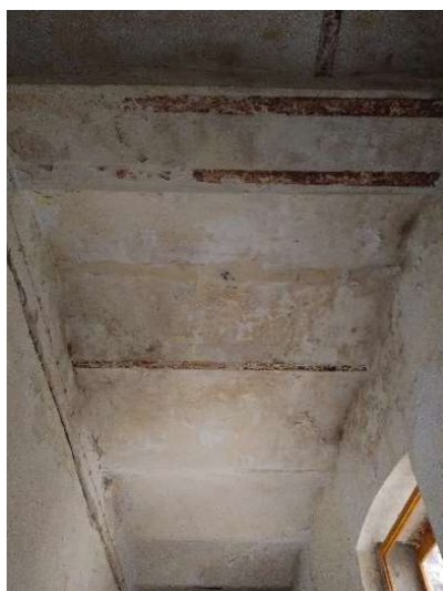
Obrázek 42: Vlhkostní mapy na klenbách a koroze ocelových nosníků valených kleneb do travers v 2.NP
