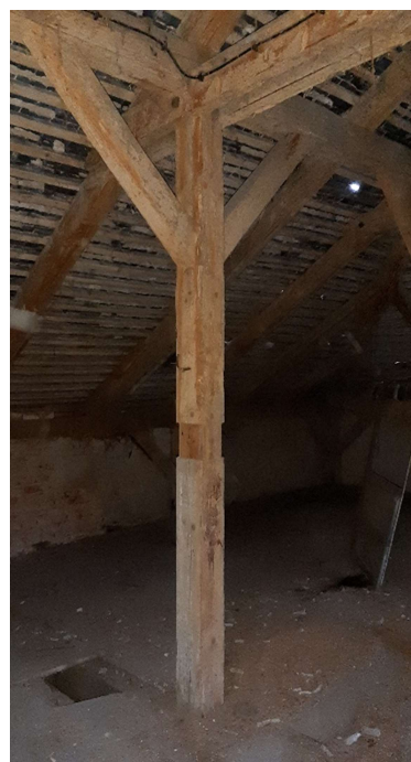
Obrázek 109: Sloupek sanovaný pomocí plombování
