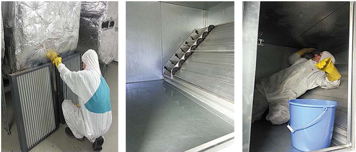
Obr. 8.2 Mokr e  ištění vzduchotechnick e jednotky [46]
