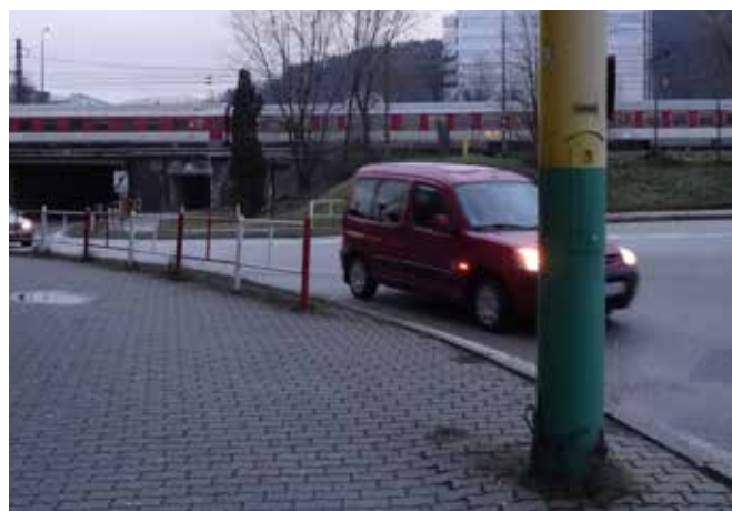
dôkaz neschopnosti stárnutia zámkovej dlažby - ul. Kálov
