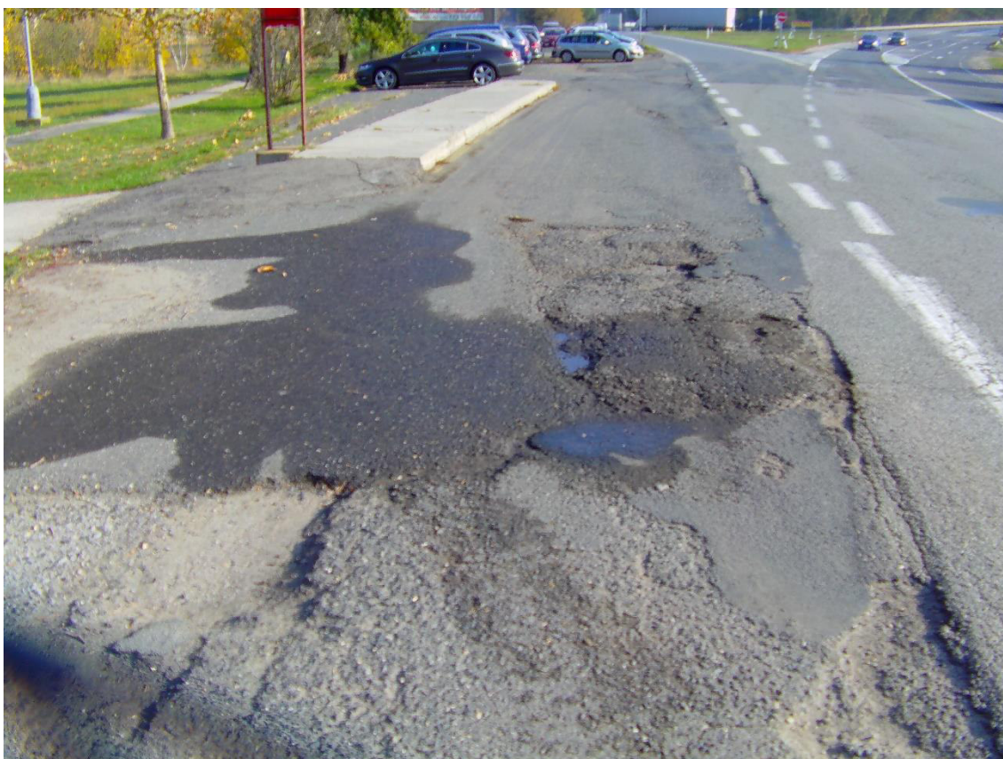
Obrázek 14: Vozovka autobusové zastávky v nevyhovujícím stavu
