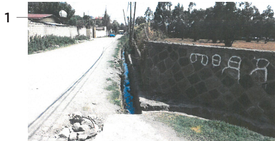
1 Zpevněná povrchová kanalizace podél východní hranice pozemku.
