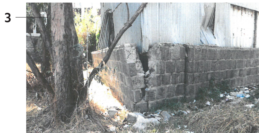
3 Patrně černá stavba (oplechované na sebe postavené kontejnery).
