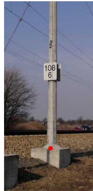
Obrázek 17: Trakční podpěra betonová [24]
