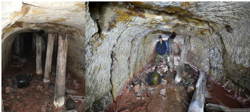
Obr. 44 – Stav podpěr v roce 2007 (M. Kolčava 2007)
