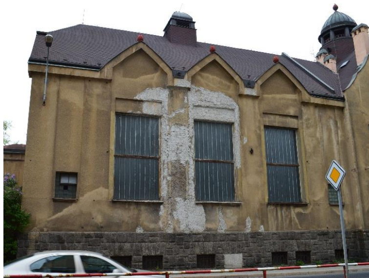
Obr. 41 Městské lázně – chátrající objekt (autor BP)
