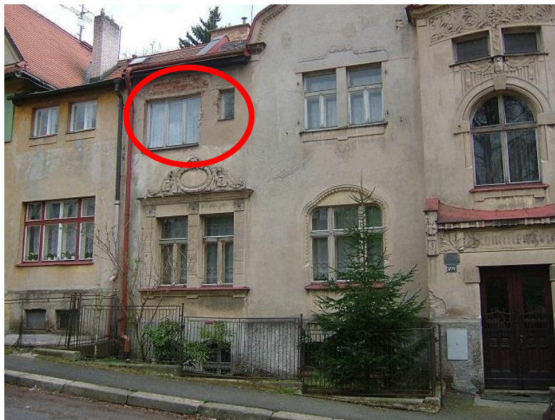
Obr. 40 Secesní budova v Jablonci s vadou na kráse – výměna okna – nedodržení členění + odstranění ornamentu nad oknem (zdroj [42])
