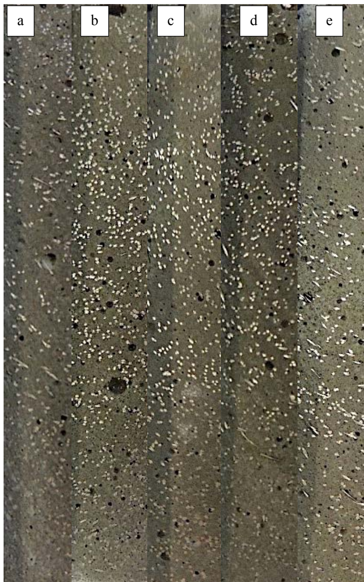
Obr. 63: Vliv zvýšené dávky plastifikátoru na distribuci vláken po výšce průřezu; a: původní receptura; b: +2 kg/m 3 ; c: +4 kg/m 3 ; d: +6 kg/m 3 ; e: +8 kg/m 3 – použito z archivu autora
