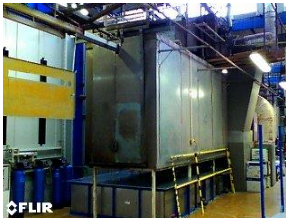
Obr. 27: Sušící komora práškové lakovny
