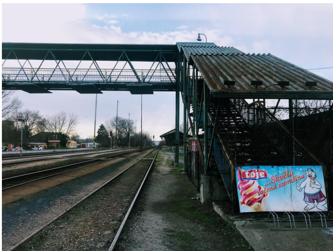
Nepřístupná lávka přes kolejště [19.3.2019]
