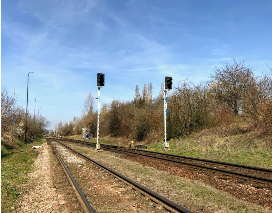
Seřadovací návěstidla Se 1 a Se 2 před kolejovou spojkou [30.3.2019]
