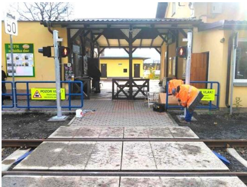
Obr. 36: Pilotní projekt s instalací VZPK v žst. Smržovka
